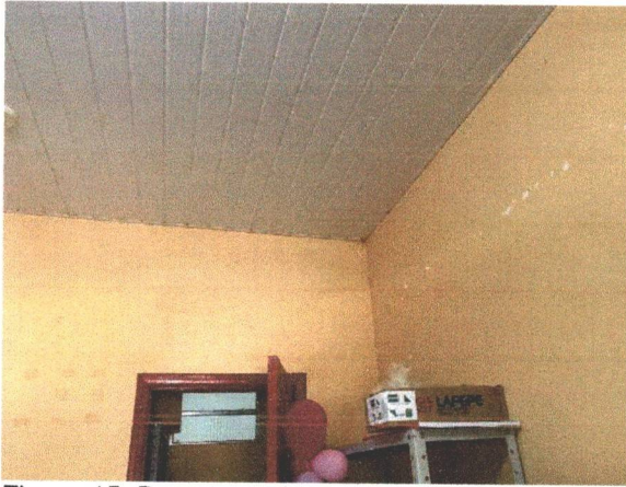
Figura 15: Danos na pintura interna.
