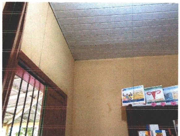
Figura 14: Goteiras no forro da farmácia.
