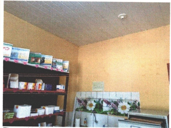
Figura 16: Falta de lâmpada e plafon.
