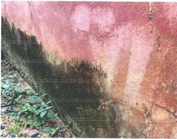
Figura 5: Infiltração no reboco do baldrame.
