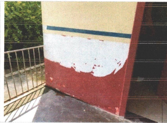
Figura 9: Descascamento de pintura.
