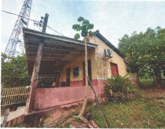
Figura 3: Pintura desgastada na área externa.
