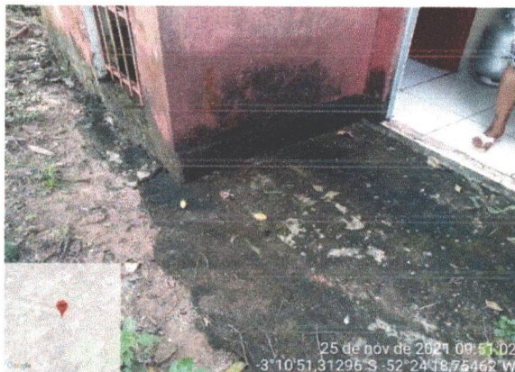
Figura 7: Piso externo com acúmulo de lodo.
