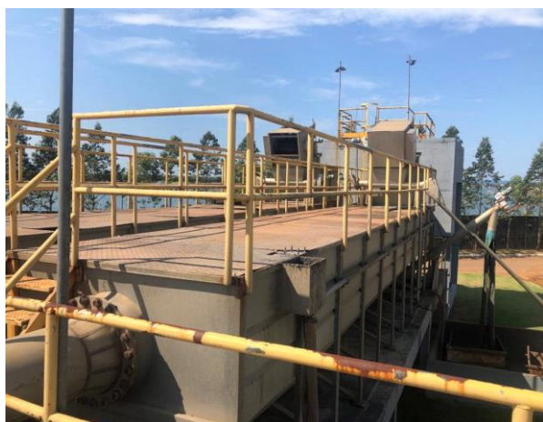
Figura 64: Tanque de Aeração
