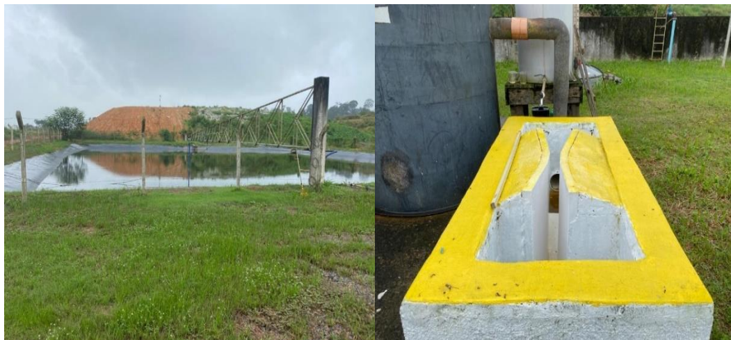
Figura 81 - Estação de Tratamento de Efluentes do Aterro Sanitário
