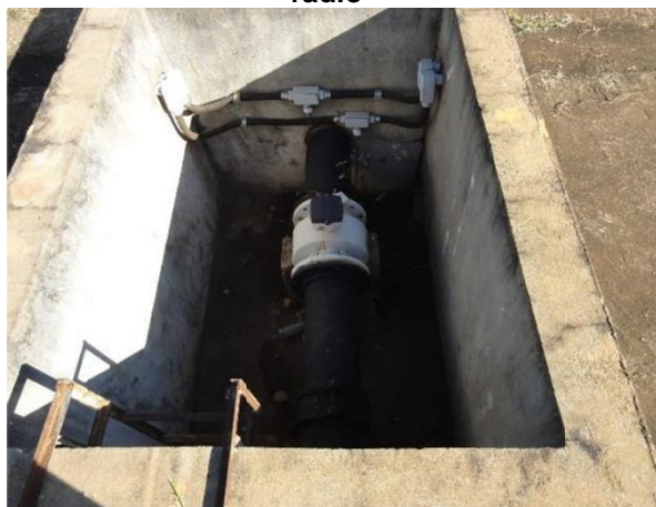
Figura 46: Medidor de Vazão na saída do Reservatório com transmissão de dados via rádio
