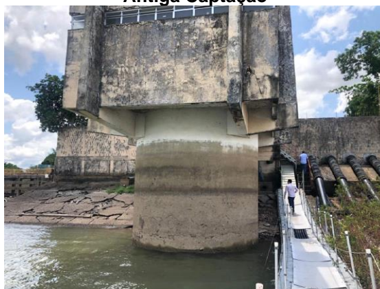
Figura 19: Detalhe da estrutura tubular onde se encontram instaladas as bombas da Antiga Captação
