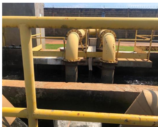
Figura 71: Elevatória de Efluente Tratado
