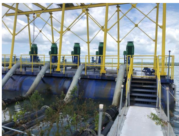
Figura 22: Vista dos conjuntos motor-bomba da Nova Captação
