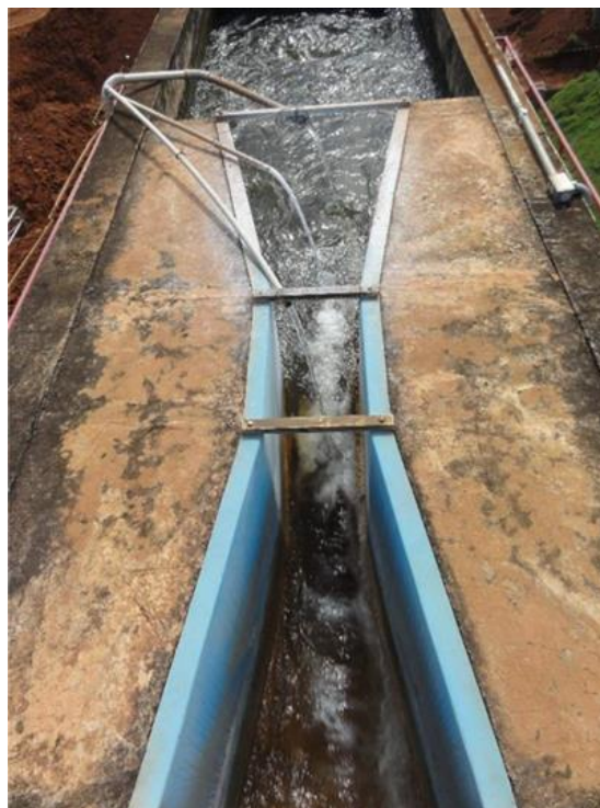
Figura 26: Vista da Calha Parshall – entrada de água bruta e aplicação de coagulante e pré-cloração
