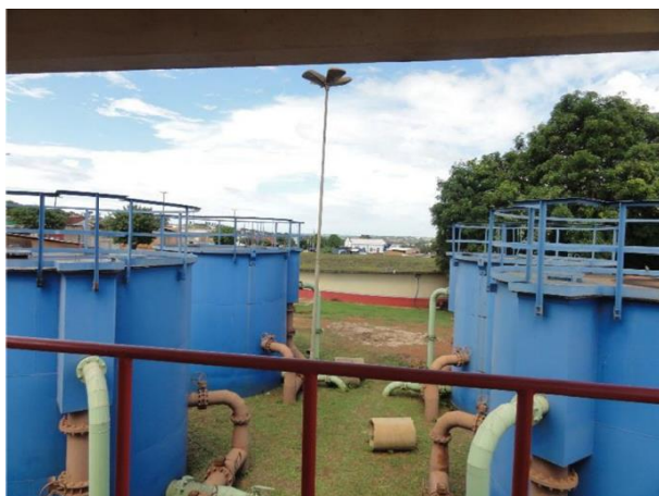
Figura 31: Vista dos Filtros Mecânicos
