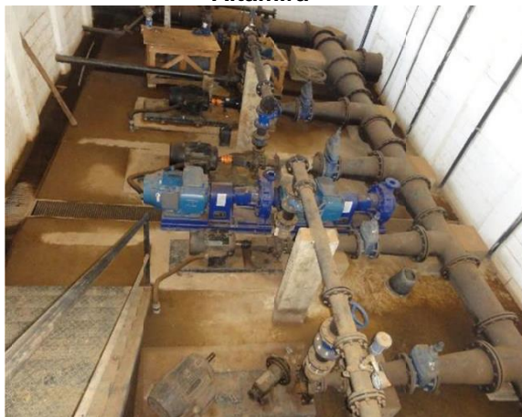
Figura 38: Elevatória com os conjuntos motor bombas que interligam RAP 08 ETA a setores Ibiza, Bela Vista e zona alta Altamira
