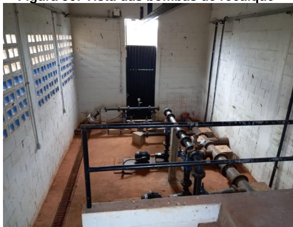
Figura 50: Vista das bombas de recalque
