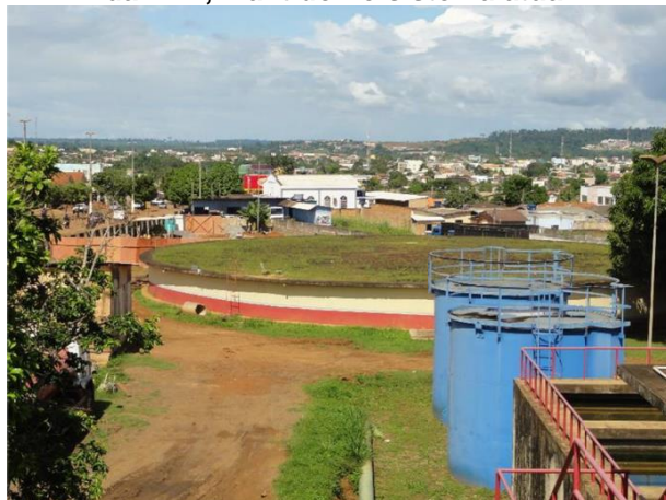
Figura 34 Vista do RAP Altamira, situado na área da ETA, mantido no sistema atual
