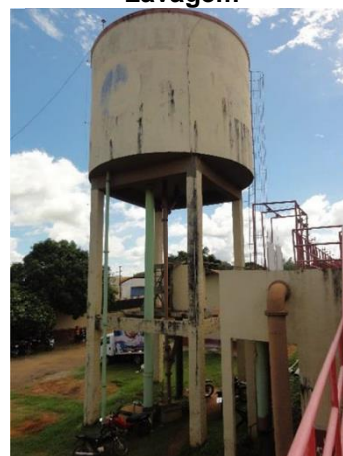
Figura 32: Reservatório de Água de Lavagem
