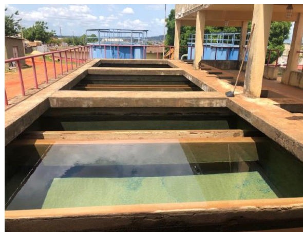
Figura 30: Vista dos Filtros em concreto
