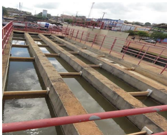
Figura 28: Vista de 01 módulo do Floculador da Antiga ETA
