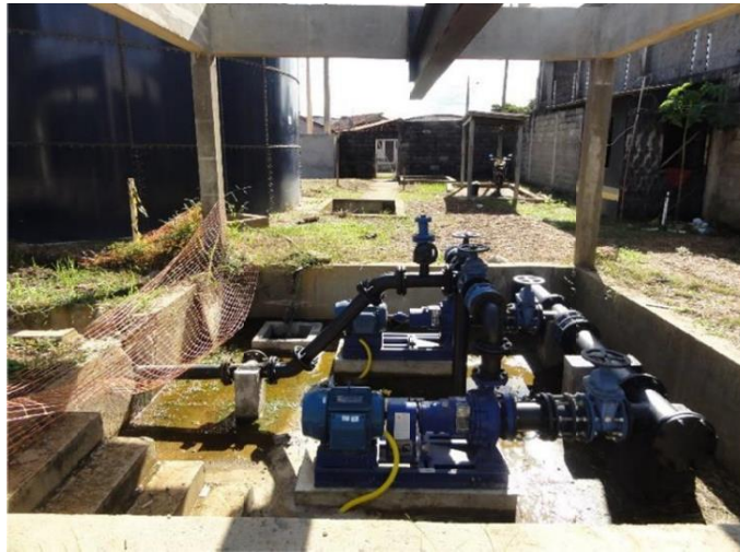
Figura 44: Booster para atender o REL Bela Vista, situado junto ao RAP 04 Bela Vista
