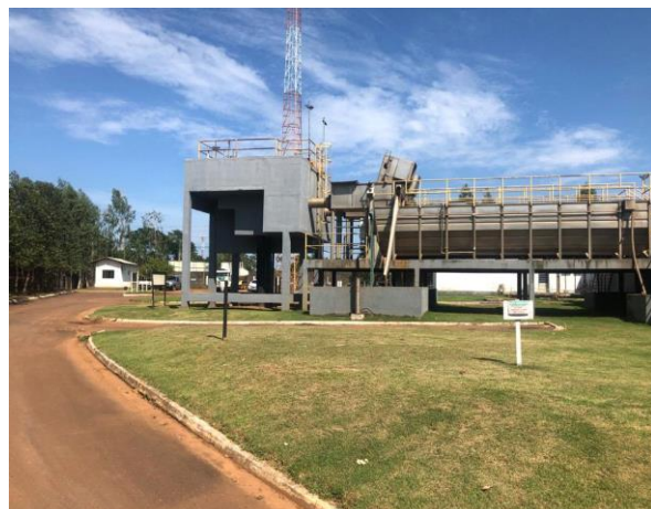
Figura 61: SKID de tratamento preliminar
