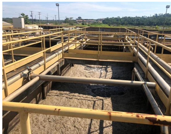
Figura 63: Tanque de Aeração
