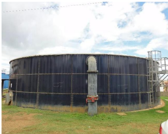
Figura 37: Vista do RAP 08 ETA, situado na área da ETA, capacidade de 1.000 m 3
