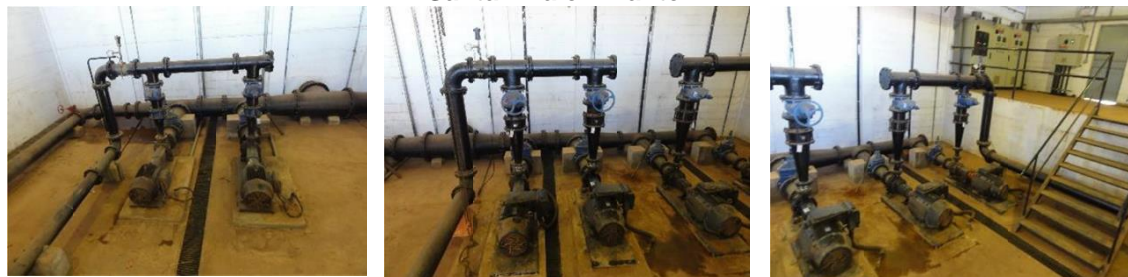
Figura 41 Instalação dos conjuntos motor-bomba que abastecem os setores Mutirão, Santa Ana e Mirante
