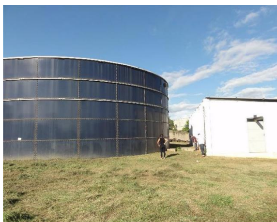
Figura 39: Vista do RAP 03 Brasília, capacidade de 2000 m 3
