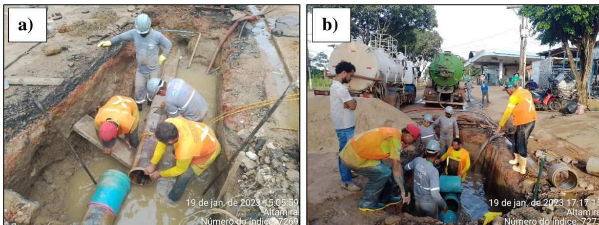
Figura 2- Reparo em adutora de água tratada na Av. Perimetral realizado no dia 19 jan. 2023.
