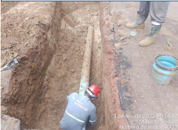
Figura 1: Avenida Presidente Mendes Reparo em RDA adutora 150mm
