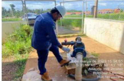
FOTO 01: Coleta de Água torneira do Poço, antes do filtro.
