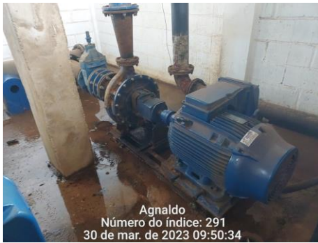
Bomba BELA VISTA – ETA para o RAP
