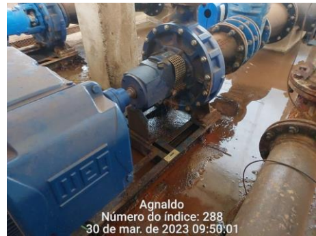
Bomba BELA VISTA – ETA para o RAP
