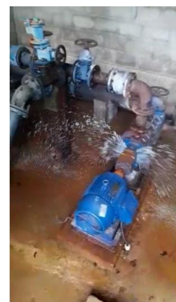
Bomba BELA VISTA – RAP para REL
