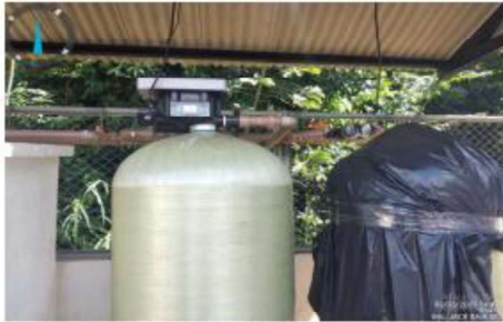
FOTO 01: RUA JURUNA CASA Nº 17
