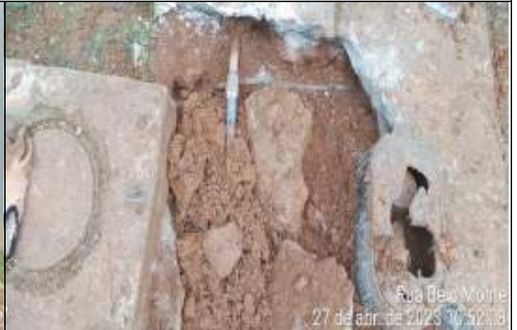
FOTO 02 – no monitoramento a nossa equipe identificou que a caixinha do hidrômetro estava danificado ocasionando o vazamento. Foi realizado a ligação direta da água e o fluxo voltou ao normal. DEMANDA ATENDIDA
