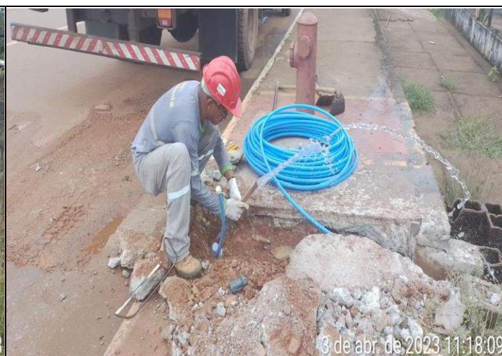
FOTO 02- A empresa Hidro Ambiental foi acionada para realizar atendimento,
