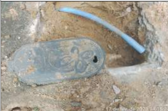
FOTO 01 – A empresa Hidro Ambiental efetuou uma interligação da espera localizada na calçada ao hidrômetro;
