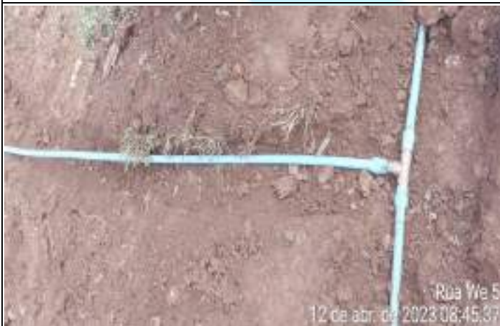
FOTO 03 - na inspeção foi realizado a ligação do ramal de água até a caixa de água da residência.
