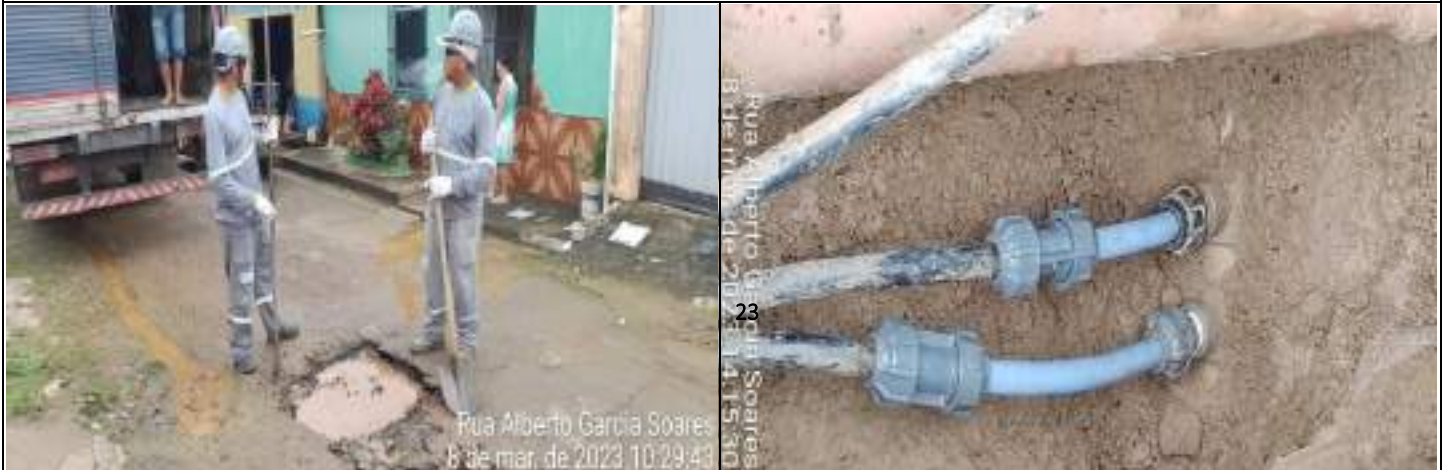
FOTO 01 – RUA CONSUELO BORGES, 29-30, ALBERTO SOARES A empresa Hidro Ambiental foi acionada para realizar atendimento
