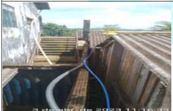
FOTO 03 - no monitoramento nossa equipe realizou a ligação de água da espera que estava na calçada até a caixa de água da residência.
