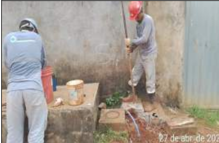
FOTO 01 – RUA BELO MONTE, Nº 16, BRASÍLIA A empresa Hidro Ambiental foi acionada para realizar atendimento
