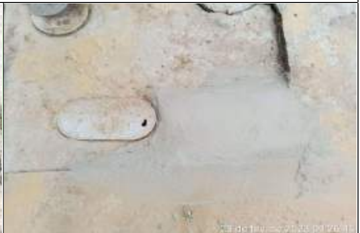
FOTO 02 – Durante a execução do serviço houve escavação, reaterro, compactação manual e mecanizada;
