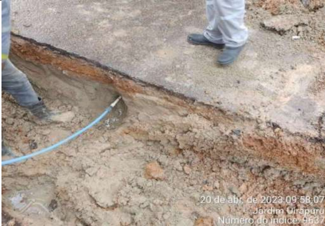
RUA ALAMEDA POLIVALENTE -BAIRRO CENTRO
