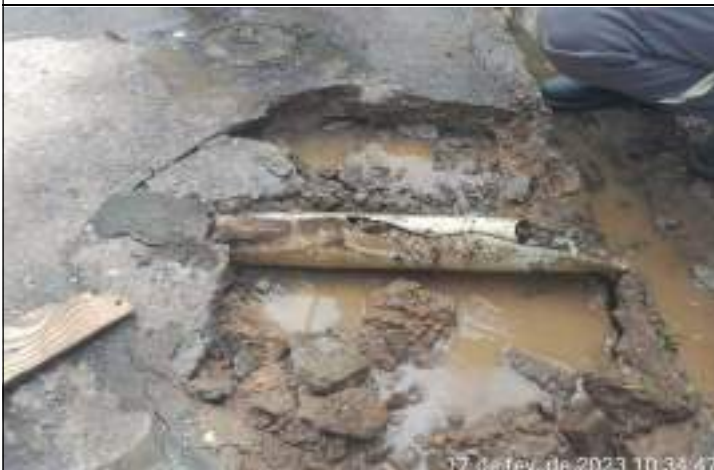
FOTO 01 – A empresa Hidro Ambiental foi acionada para realizar atendimento, nossa equipe identificou vazamento na rede de distribuição de água;
