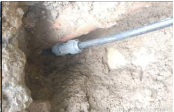
FOTO 02 – Efetuou-se a substituição da luva de união, corrigindo o problema, e o vazamento foi reparado;
