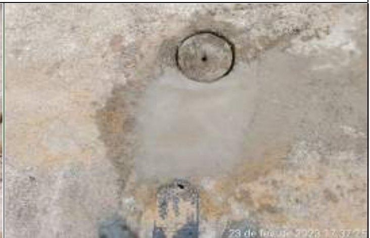
FOTO 02 – Durante a execução do serviço houve escavação, reaterro, compactação manual e mecanizada;
