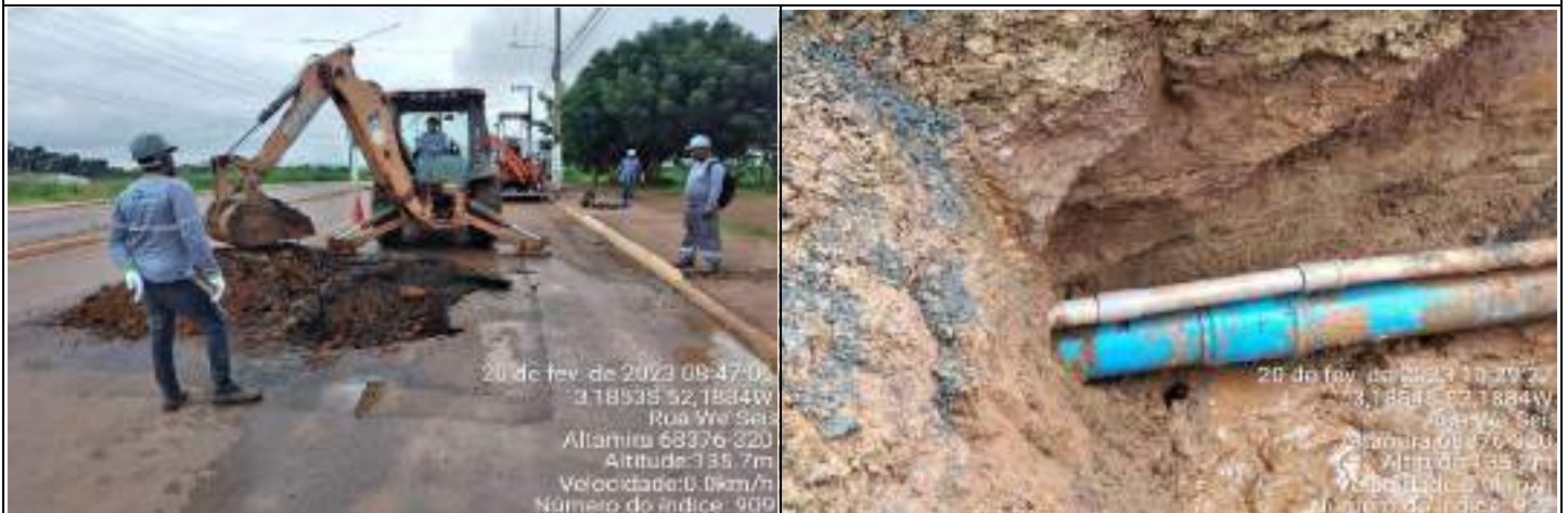
FOTO 01 – RODOVIA ENERSTO ACIOLE, S/N, COLINAS No monitoramento a nossa equipe identificou que a bolsa estava com o anel torcido
