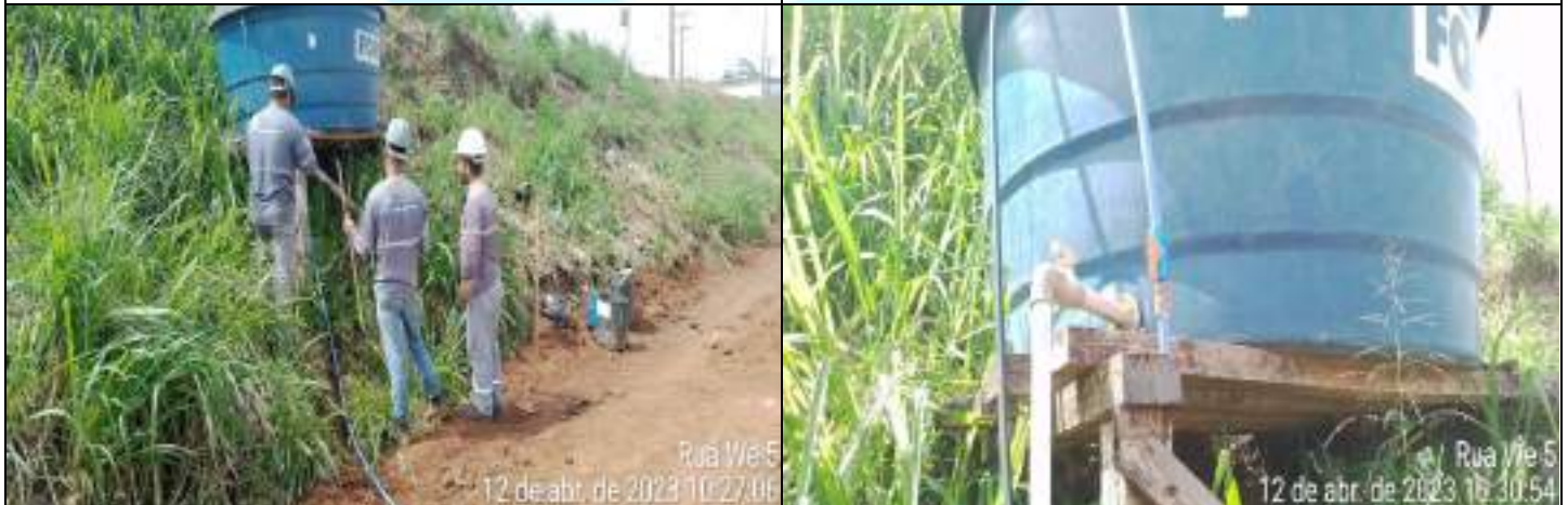
FOTO 03 - na inspeção foi realizado a ligação do ramal de água até a caixa de água da residência.
