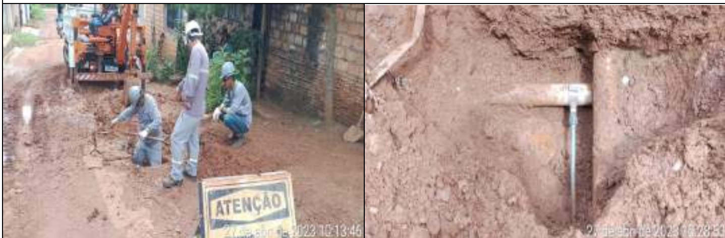
FOTO 01 – RUA BELO MONTE, Nº 16, BRASÍLIA A empresa Hidro Ambiental foi acionada para realizar atendimento
