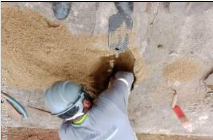
FOTO 01 – A empresa Hidro Ambiental efetuou uma interligação da espera localizada na calçada ao hidrômetro;
