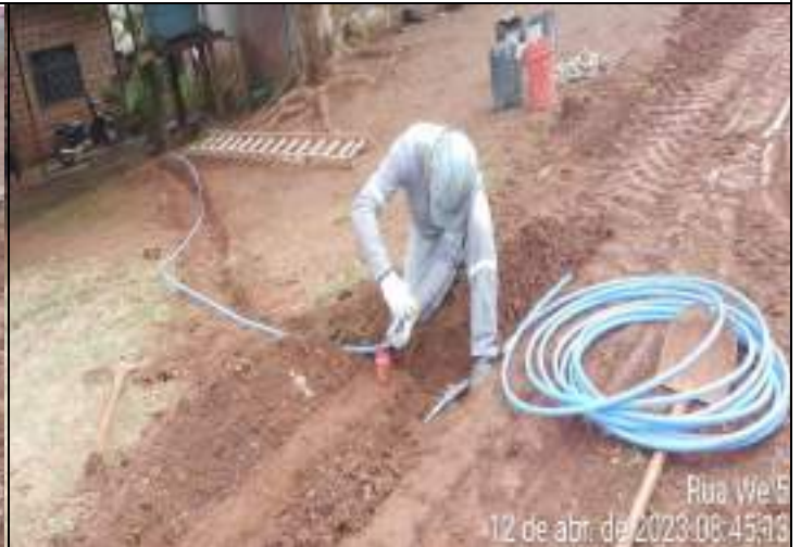
FOTO 02 - A empresa Hidro Ambiental foi acionada para realizar atendimento,
