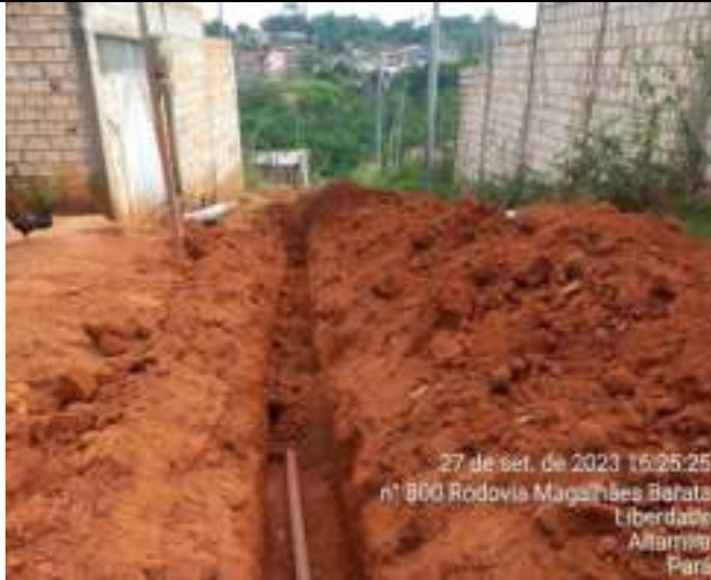
RUA BOM SOSSEGO- BAIRRO PAIXÃO DE CRISTO
