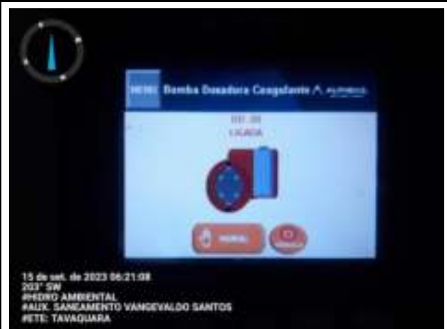
MONITORAMENTO DA DOSADORA COAGULANTE
