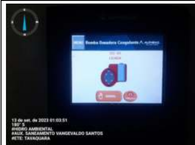
MONITORAMENTO DA DOSADORA COAGULANTE
