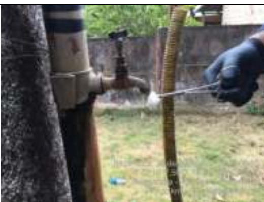
Foto 25: Esterilização com fogo – torneira de metal
