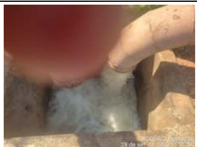
DESCARGA FILTRO DE METAL ETA CONVENCIONAL
