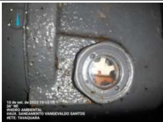
MONITORAMENTO DO ÓLEO DO SOPRADOR
