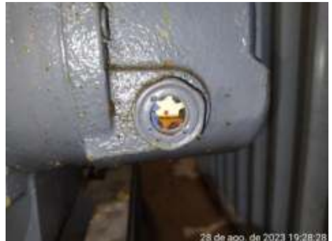
CONTROLE DO NÍVEL DO ÓLEO DO SOPRADOR
