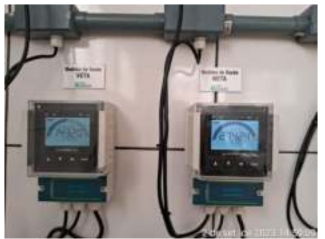
MONITORAMENTO DA VASÃO
