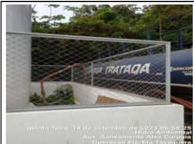
ABASTECIMENTO DA CX D'ÁGUA COM CARRO PIPA PORQUE A BOMBA TA COM DEFEITO.
