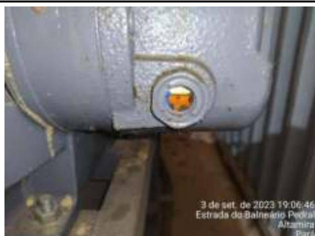
MONITORAMENTO ÓLEO DO SAPRADOR
