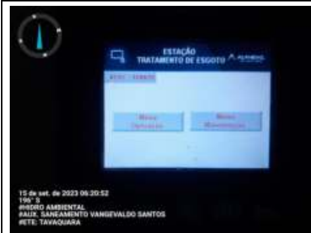
MONITORAMENTO DO PAINEL DE OPERAÇÃO
