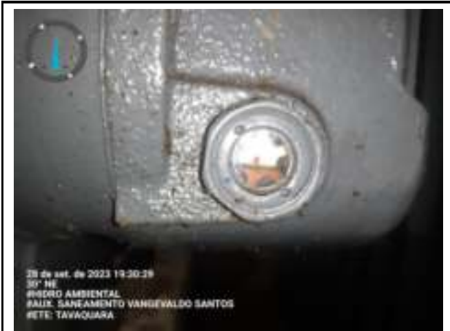
MONITORAMENTO DO ÓLEO DO SOPRADOR
