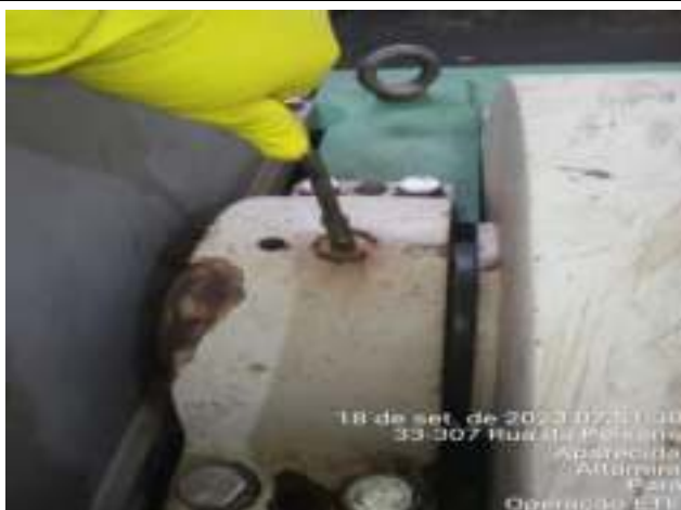
LUBRIFICAÇÃO DA CENTRÍFUGA
