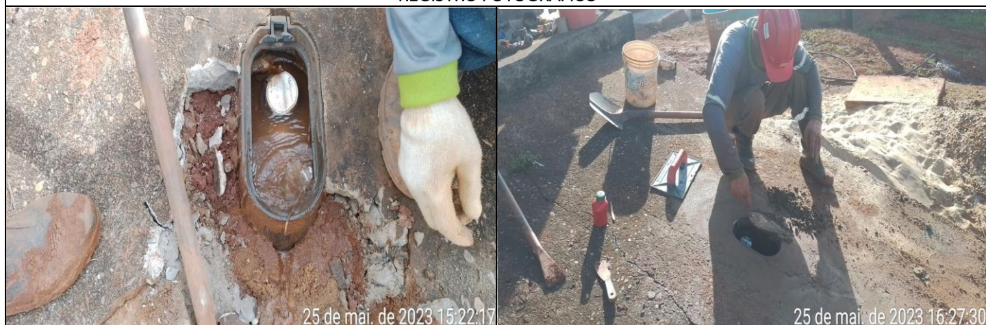
FOTO 01 – RUA HORACIO BANNER, Nº 2471 A empresa Hidro Ambiental foi acionada para realizar atendimento
