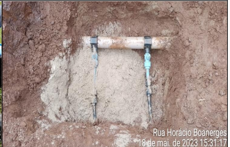
FOTO 02 – no monitoramento a nossa equipe identificou que dois PEAD estavam curtos ocasionado o vazamento, foi realizado a troca dos mesmos para que o fluxo voltasse ao normal. DEMANDA ATENDIDA
