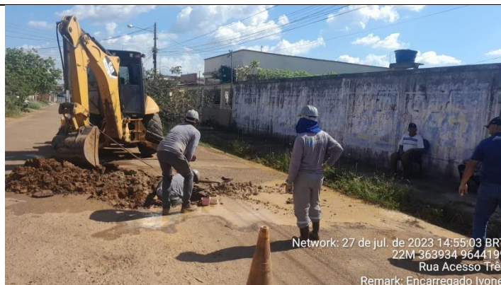
RUA MANOEL MENEZES COM ACESSO 03- INDEPENDENTE 01 DIA 28.07.2023- CONSERTO DE VAZAMENTO NA REDE
