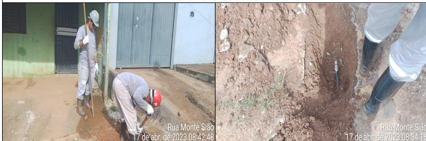
FOTO 01 – A empresa hidro ambiental foi acionada para realizar atendimento,
