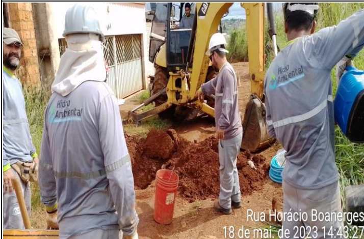
FOTO 01 – RUA HORACIO BOANERGES, Nº 184 e 210, BRASÍLIA
