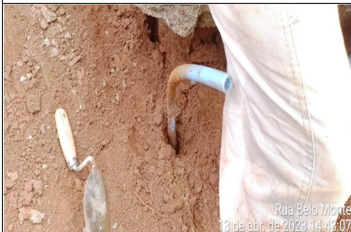
FOTO 01 – A empresa hidro ambiental foi acionada para realizara atendimento,
