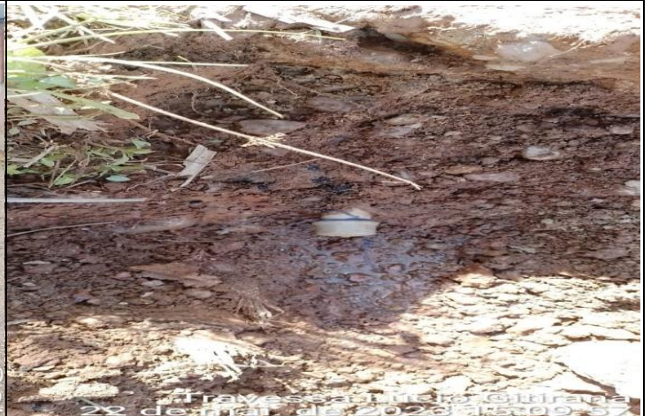
FOTO 02 – no monitoramento nossa equipe constatou que o vazamento ocorria de uma mangueira solta, foi colocado um TAP no mesmo para que o vazamento fosse contido. DEMANDA ATENDIDA
