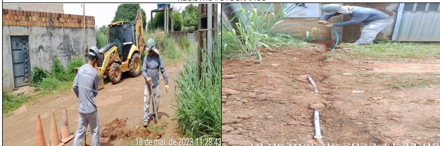
FOTO 01 –RUA HORACIO BOANERGES, Nº 1340, BRASÍLIA A empresa Hidro Ambiental foi acionada para realizar atendimento
