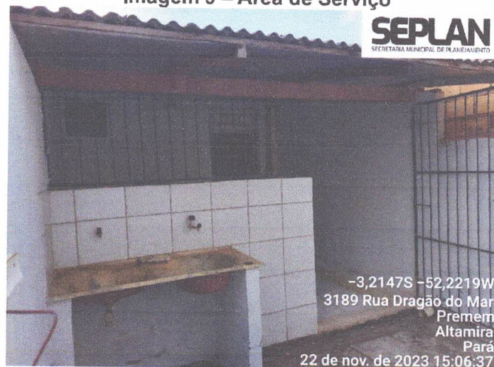
Imagem 9 – Área de Serviço
