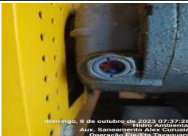
MONITORAMENTO DO ÓLEO DO SOPRADOR
