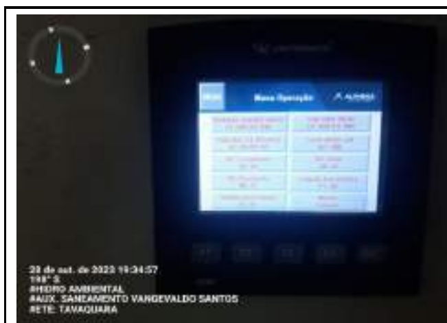
VERIFICAÇÃO DO PAINEL DE OPERAÇÃO
