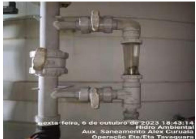
VERIFICAÇÃO DOS ROTÂMETROS
