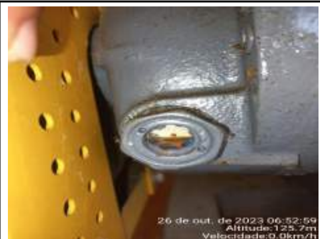
VERIFICAÇÃO DO ÓLEO DO SOPRADOR
