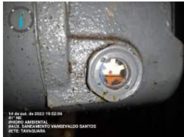
VERIFICAÇÃO DO ÓLEO DO SOPRADOR
