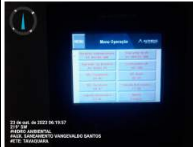
VERIFICAÇÃO DO PAINEL DE CONTROLE
