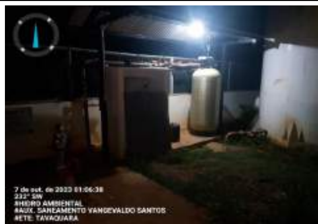
MONITORAMENTO DA ETA
