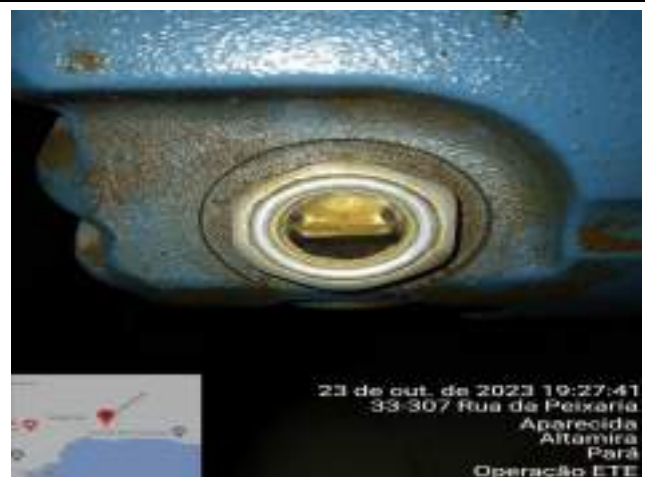
VERIFICAÇÃO DO ÓLEO DO SOPRADOR
