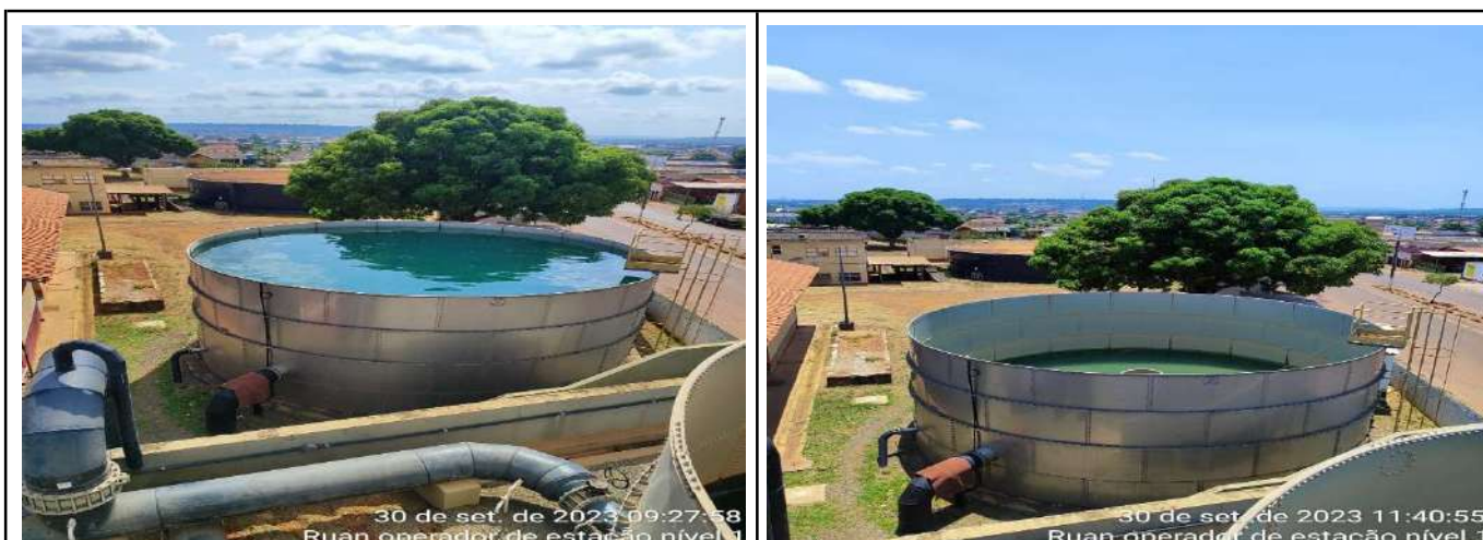
MANOBRA DE RECUPERAÇÃO DE ÁGUA CLARIFICADA PARA O INÍCIO DO SISTEMA DE TRATAMENTO
