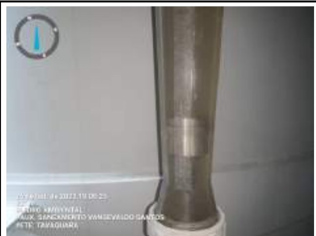
VERIFICAÇÃO DOS ROTÂMETROS
