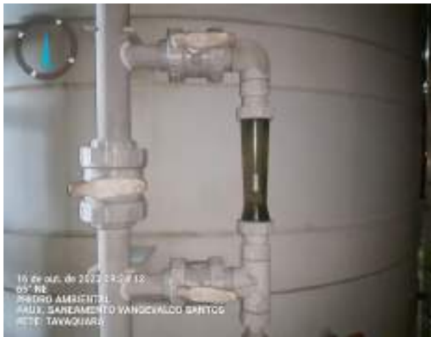
VERIFICAÇÃO DOS ROTÂMETROS
