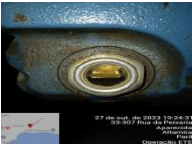
VERIFICAÇÃO DO ÓLEO DO SOPRADOR
