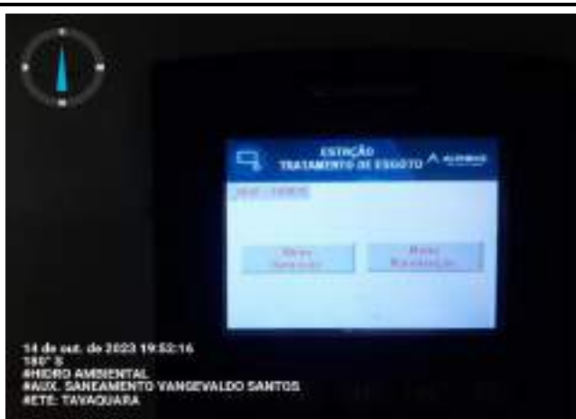
VERIFICAÇÃO DO PAINEL DE OPERAÇÃO
