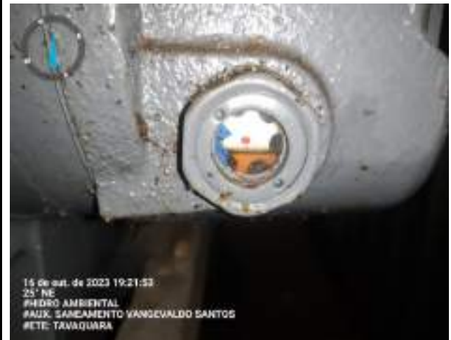
VERIFICAÇÃO DO ÓLEO DO SOPRADOR
