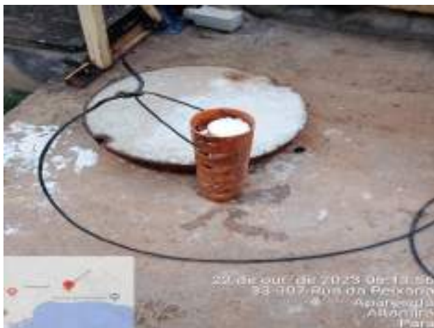
ADIÇÃO DE CLORO NO EMISSARIO FINAL
