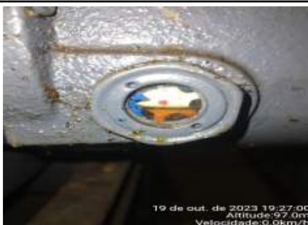
VERIFICAÇÃO DO ÓLEO DO SOPRADOR
