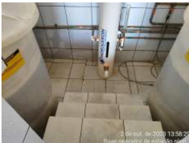
ABASTECIMENTO DAS TINAS DE SAL
