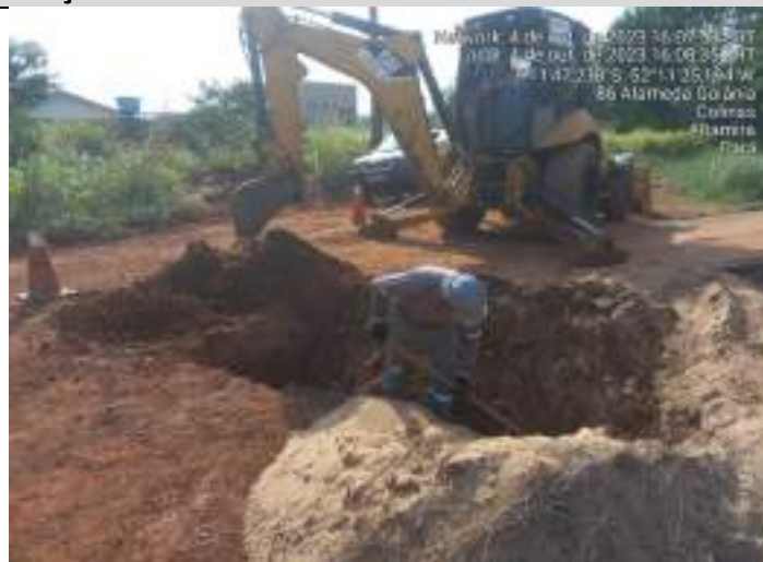
ALAMEDA GOIANA LOTE 11 BAIRRO ALTAVILLI
