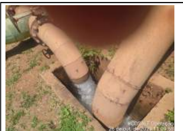
LAVAGEM DOS FILTROS METAL ETA CONVENCIONAL
