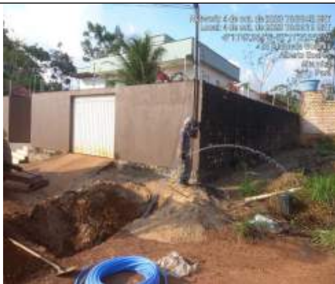
ALAMEDA GOIANA LOTE 11 BAIRRO ALTAVILLI
