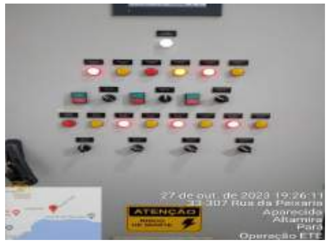
VERIFICAÇÃO DO PAINEL DOS SOPRADORES
