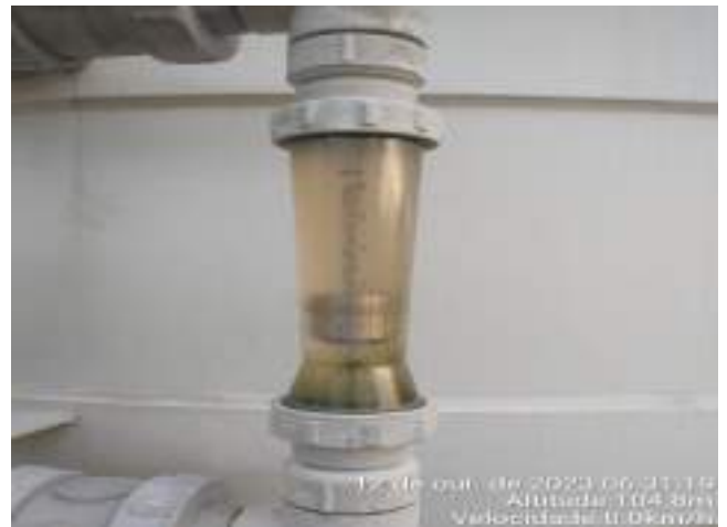
VERIFICAÇÃO DOS ROTÂMENTOS
