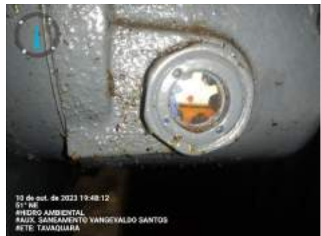
MONITORAMENTO DO ÓLEO DO SOPRADOR
