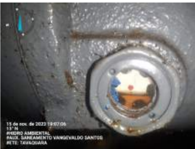
VERIFICAÇÃO DO ÓLEO DOS SOPRADORES
