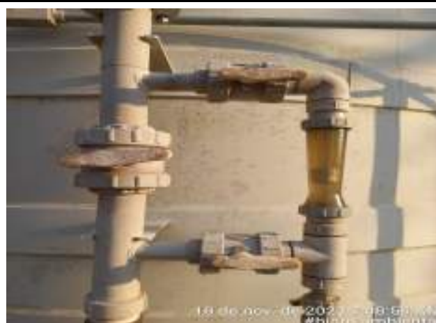
FEITO E VERIFICAÇÃO DOS ROTÂMETROS
