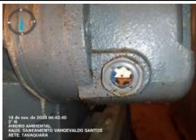
VERIFICAÇÃO DO ÓLEO DO SOPRADOR
