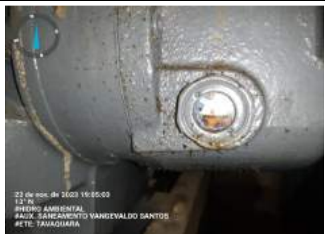
VERIFICAÇÃO DO ÓLEO DO SOPRADOR
