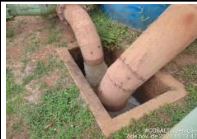
DESCARGA NOS FILTROS METAL ETÁ CONVENCIONAL
