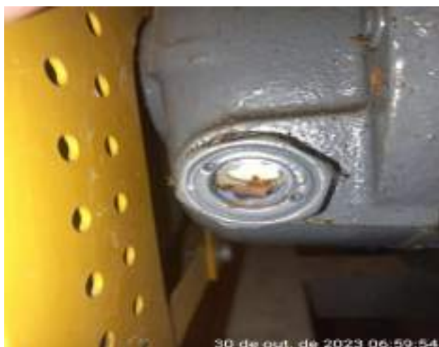
VERIFICAÇÃO DO ÓLEO DO SOPRADOR
