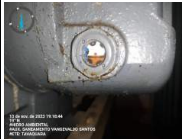
VERIFICAÇÃO DO ÓLEO DO SOPRADOR
