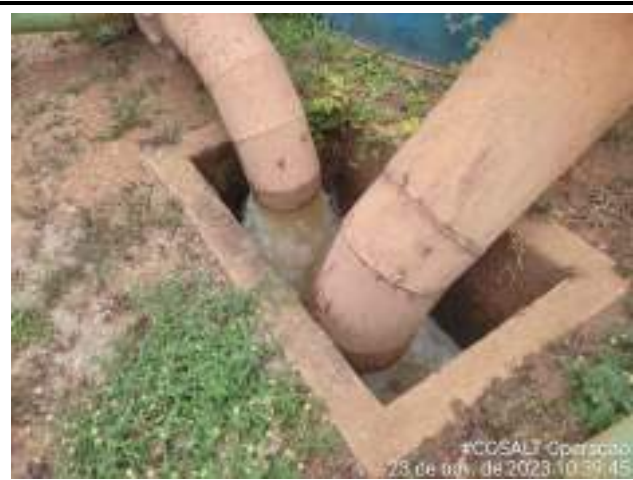
DESCARGA DOS FILTROS DE METAL DA VETA
