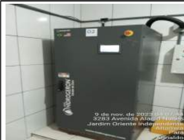
GERADORES FUNCIONANDO NORMALMENTE
