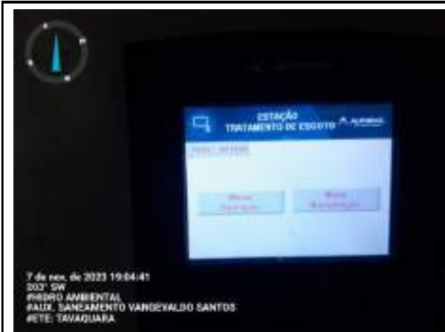
MONITORAMENTO DO PAINEL DE OPERAÇÃO
