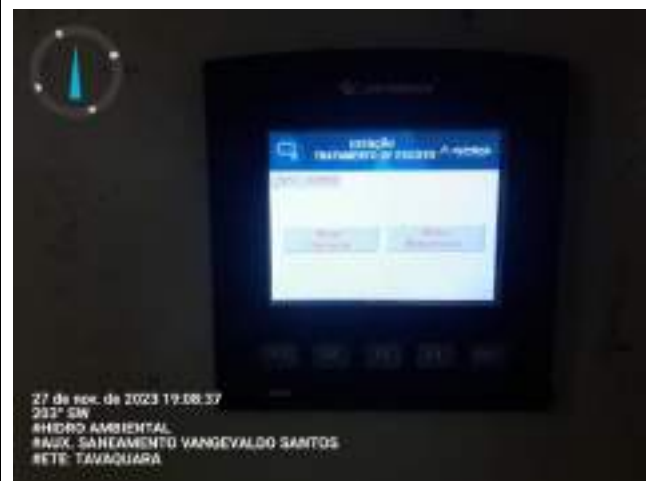
VERIFICAÇÃO DO PAINEL DE OPERAÇÃO
