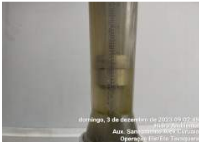
VERIFICAÇÃO DOS ROTÂMETROS
