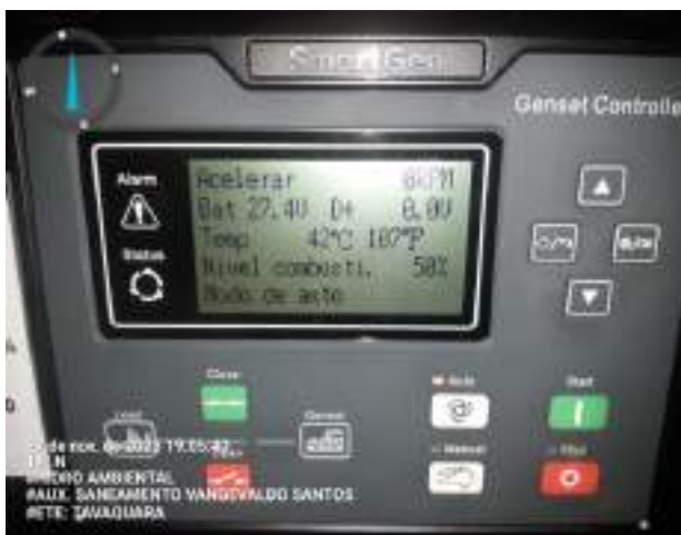
NIVEL DO ÓLEO DO GERADOR EM 50%
