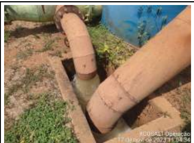
DESCARGA DOS FILTROS DE METAL DA VETA
