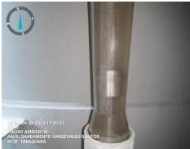
VERIFICAÇÃO DOS ROTÂMETROS
