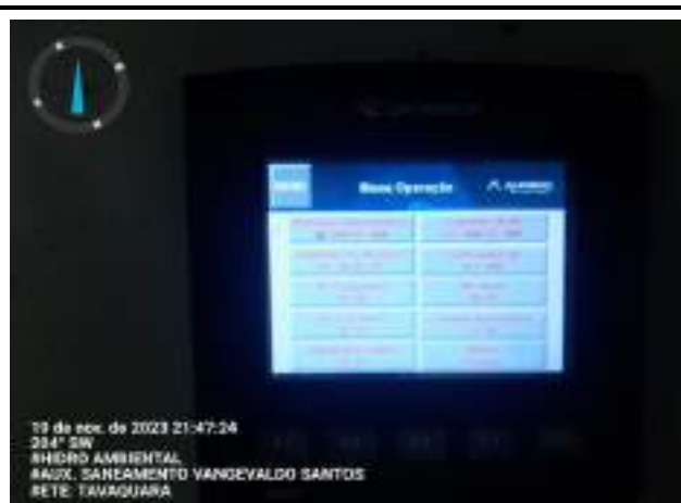
MONITORAMENTO DO PAINEL DE OPERAÇÃO
