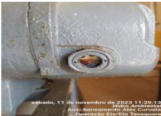
VERIFICAÇÃO DO ÓLEO DO SOPRADOR
