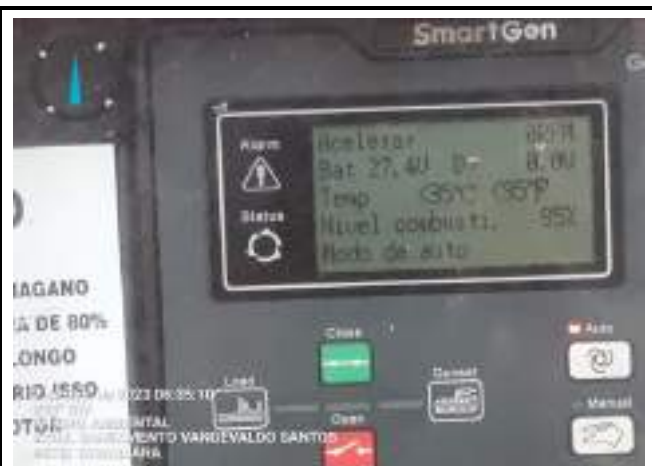
NÍVEL DO ÓLEO DO GERADOR EM 95%
