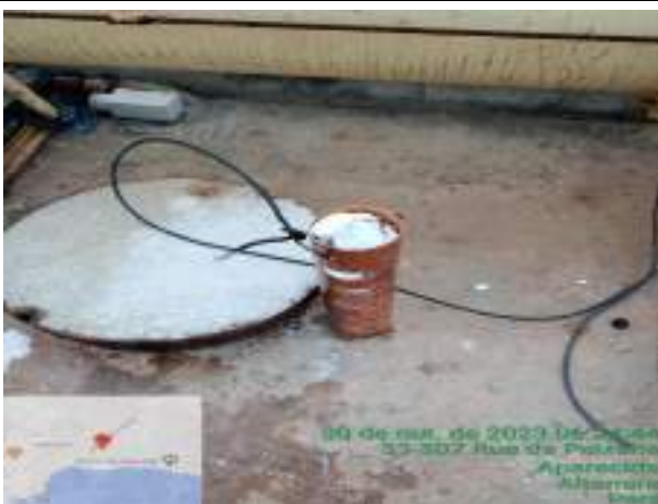
ADIÇÃO DE PASTILHA DE CLORO EMISSÁRIO FINAL
