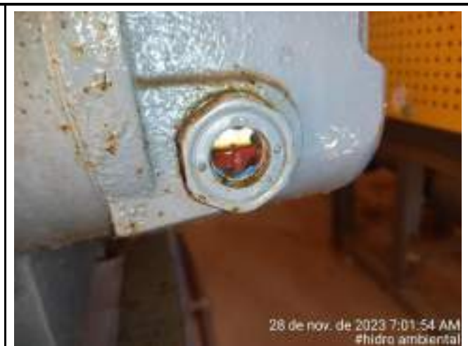
VERIFICAÇÃO DO ÓLEO DO SOPRADOR
