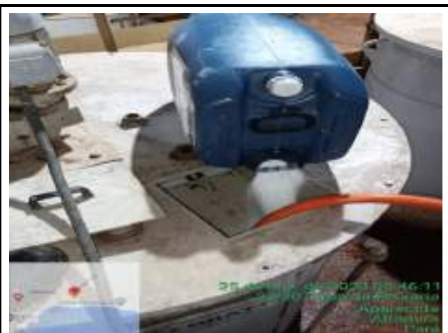
ADIÇÃO DE PASTILHA DE CLORO EMISSÁRIO FINAL
