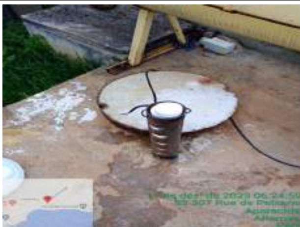
ADIÇÃO DE CLORO NO EMISSÁRIO FINAL
