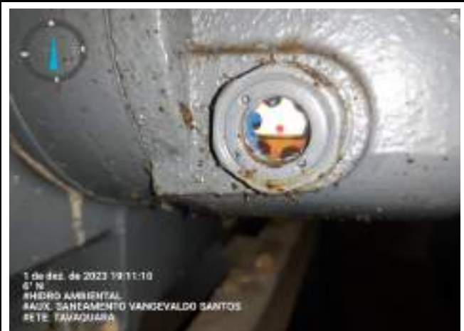
VERIFICAÇÃO DO ÓLEO DO SOPRADOR
