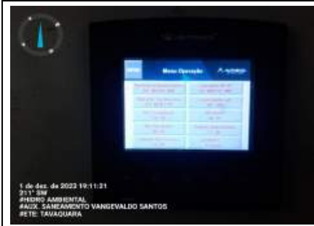
MONITORAMENTO DO PAINEL DOS EQUIPAMENTOS
