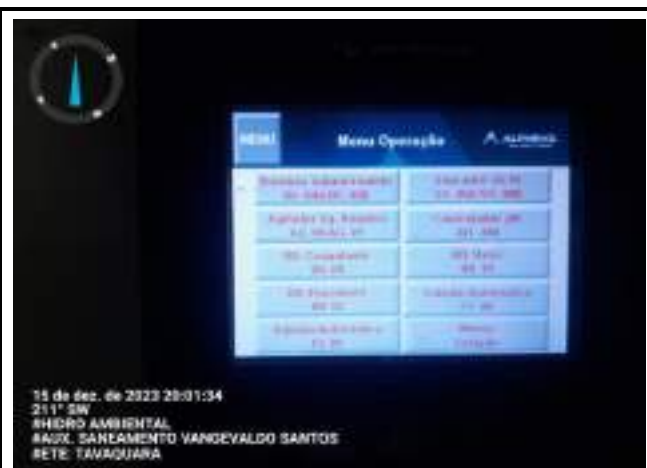
MONITORAMENTO DO PAINEL DE OPERAÇÃO
