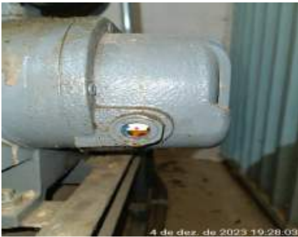
VERIFICAÇÃO DO ÓLEO DO SOPRADOR
