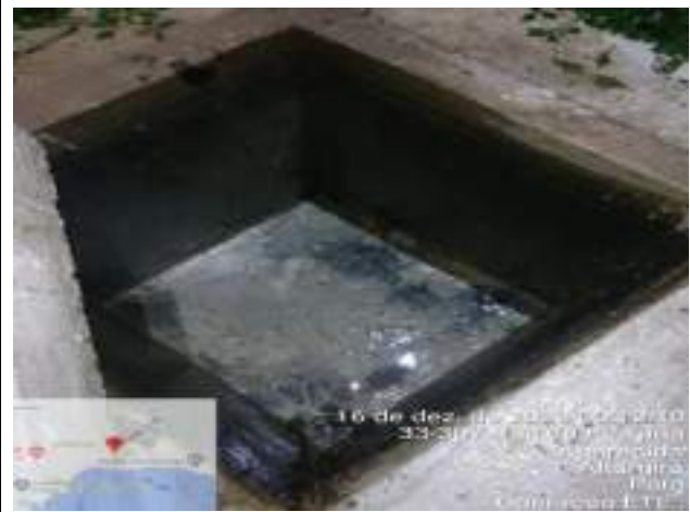
SUCÇÃO DA CAIXA DE CONTENÇÃO DA ÁREA DAS CAÇAMBAS
