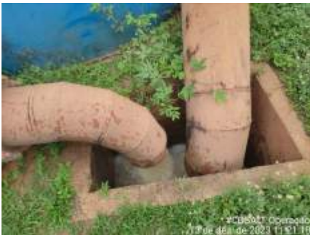
RETROLAVAGEM FILTROS DE METAL VETA
