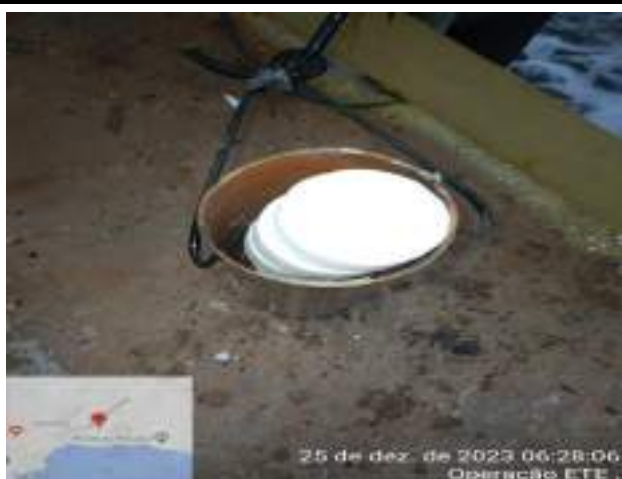
ADIÇÃO DE PASTILHA DE CLORO EMISSÁRIO FINAL
