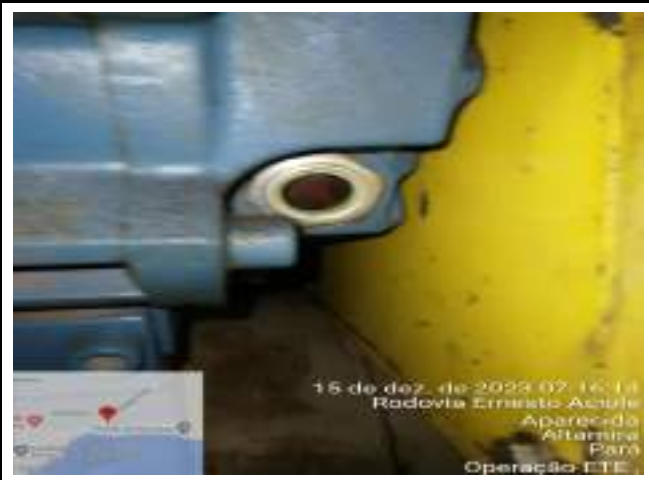
VERIFICAÇÃO DO ÓLEO DO SOPRADOR
