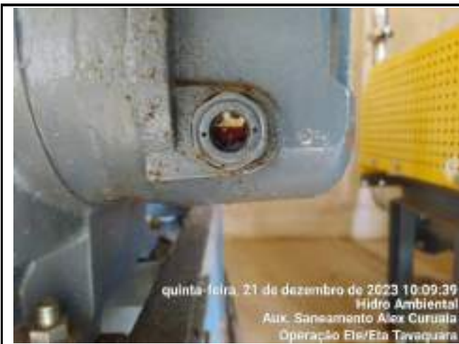
VERIFICAÇÃO DO ÓLEO DO SOPRADOR
