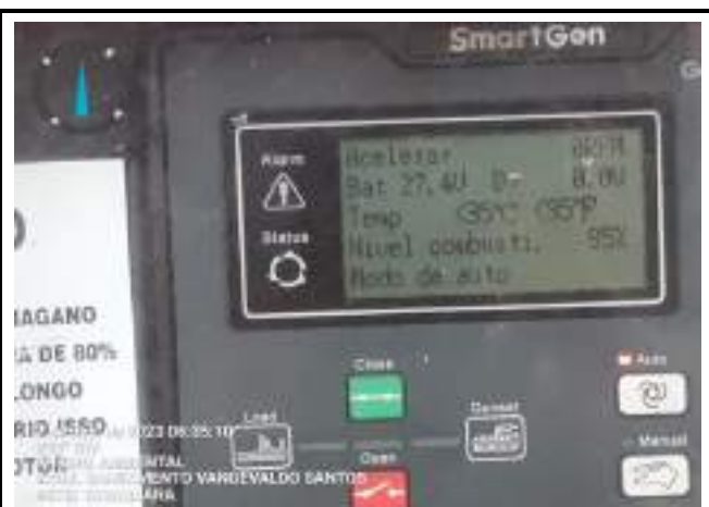
NÍVEL DO ÓLEO DO GERADOR EM 95%
