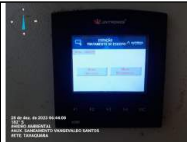
VERIFICAÇÃO DO PAINEL DE OPERAÇÃO
