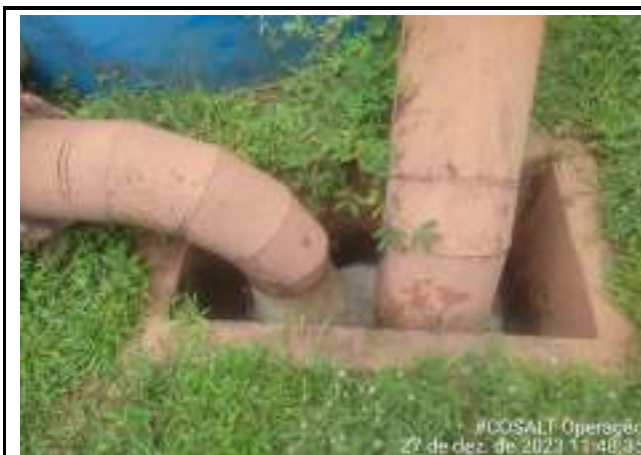
RETROLAVAGEM FILTRO DE META 3 ETA CONVENCIONAL
