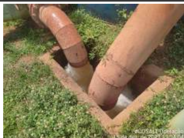
RETROLAVAGEM FILTROS DE METAL VETA
