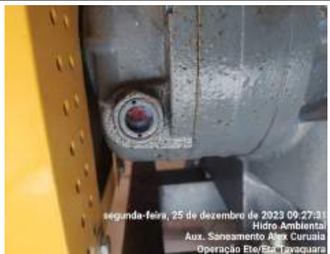
VERIFICAÇÃO DO ÓLEO DO SOPRADOR
