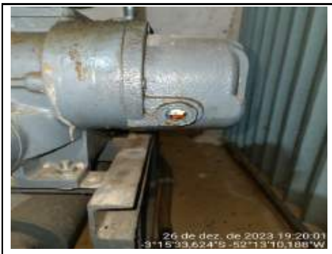
VERIFICAÇÃO DO ÓLEO DO SOPRADOR
