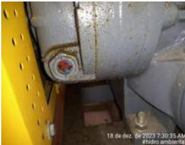
VERIFICAÇÃO DO ÓLEO DO SOPRADOR
