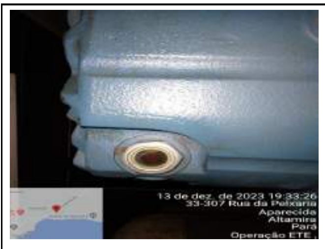
VERIFICAÇÃO DO ÓLEO DO SOPRADOR
