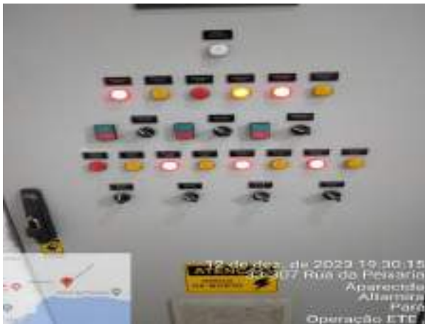
MONITORAMENTO PAINEL DOS SOPRADORES
