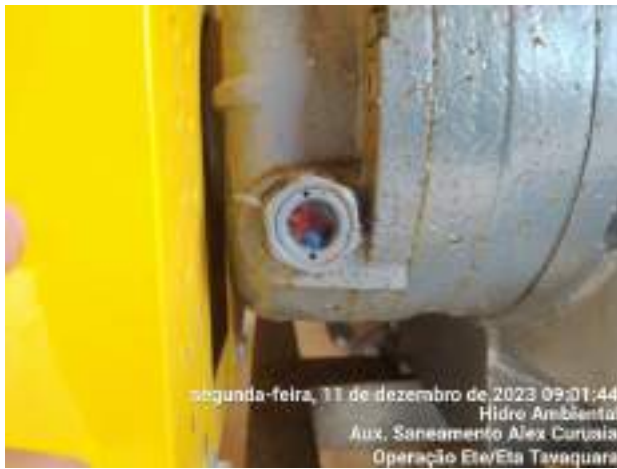
VERIFICAÇÃO DO ÓLEO DO SOPRADOR
