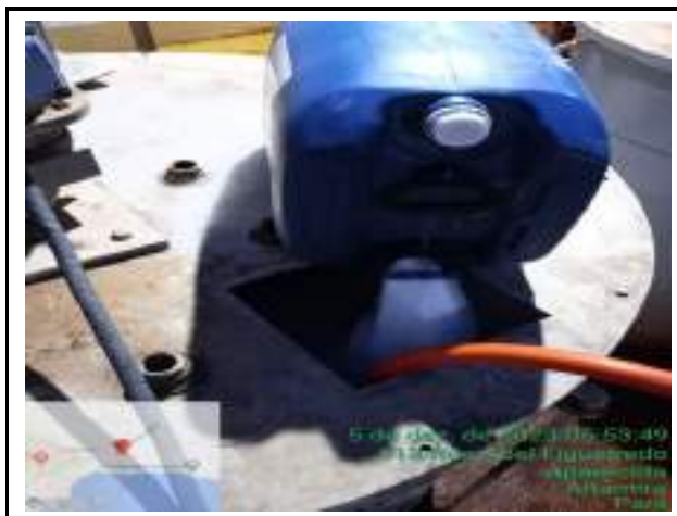
ADIÇÃO DE PASTILHA DE CLORO EMISSÁRIO FINAL
