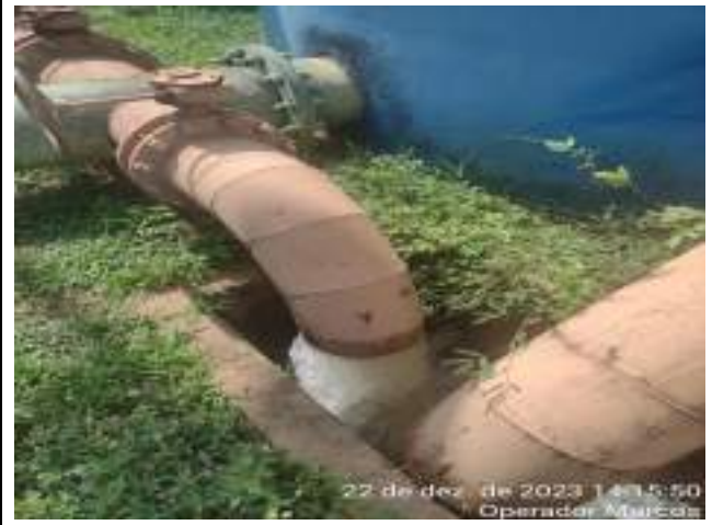
RETROLAVAGEM FILTRO DE META 2 ETA CONVENCIONAL
