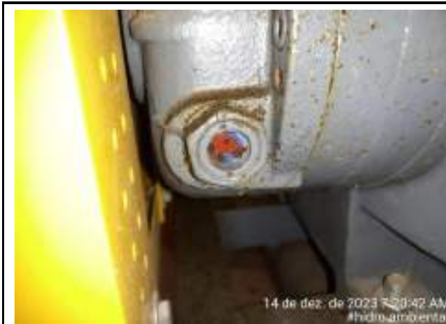
VERIFICAÇÃO DO ÓLEO DO SOPRADOR
