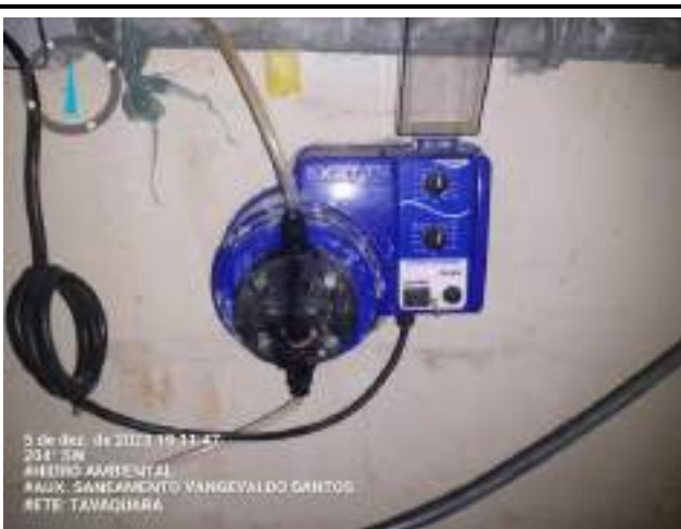
VERIFICAÇÃO DA DOSADORA DE BARRILHA
