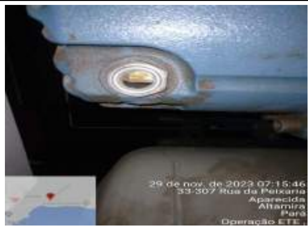
VERIFICAÇÃO DO ÓLEO DO SOPRADOR
