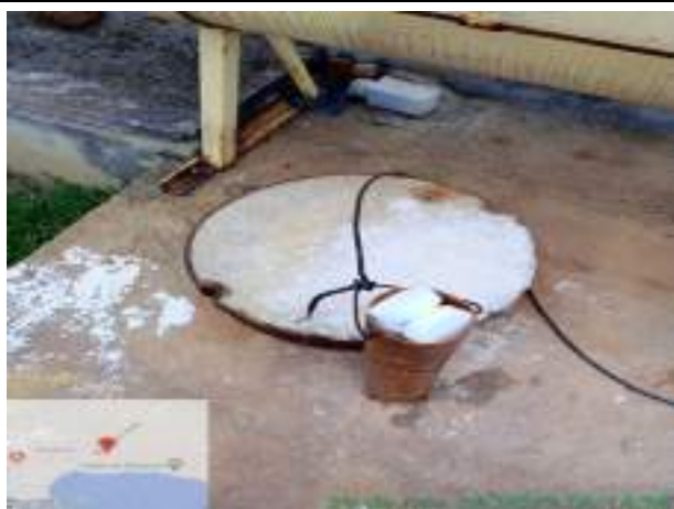
ADIÇÃO DE PASTILHA DE CLORO EMISSÁRIO FINAL
