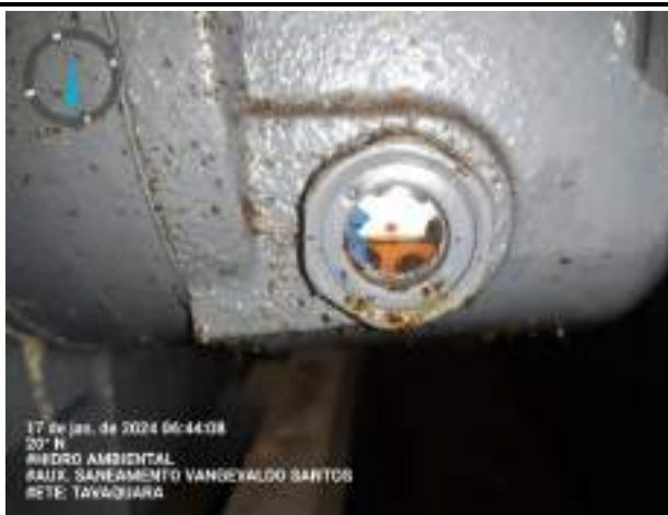
VERIFICAÇÃO DO ÓLEO DO SOPRADOR
