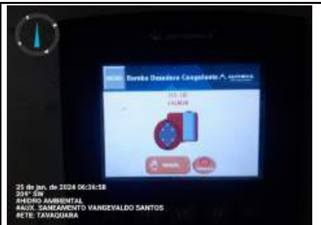
VERIFICAÇÃO DA BOMBA DOSADORA COAGULANTE
