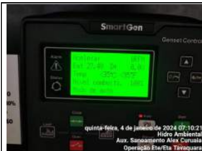
VERIFICAÇÃO NÍVEL DO ÓLEO DO GERADOR
