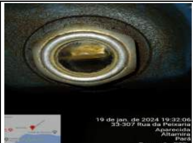
VERIFICAÇÃO DO ÓLEO DO SOPRADOR
