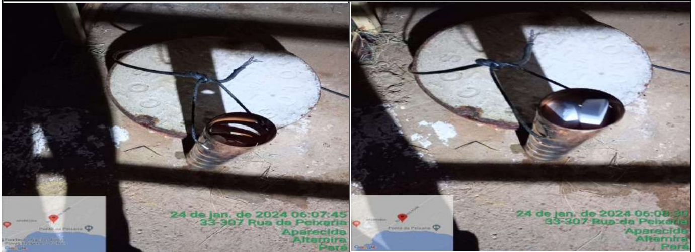
APLICAÇÃO DE PASTILHAS DE CLORO NA EEE 14 (EMISSÁRIO FINAL)
