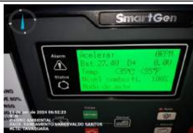
NÍVEL DO ÓLEO DO GERADOR NO FINAL DO TURNO
