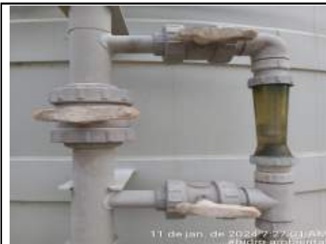
VERIFICAÇÃO DA VASÃO
