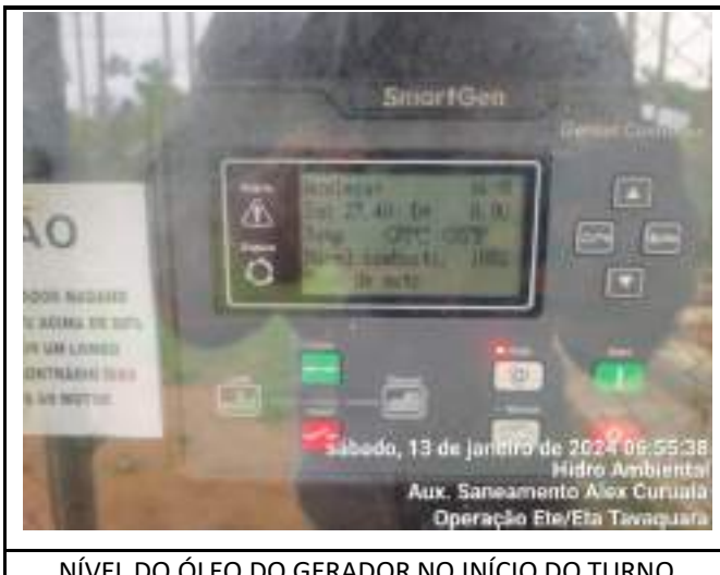
NÍVEL DO ÓLEO DO GERADOR NO INÍCIO DO TURNO
