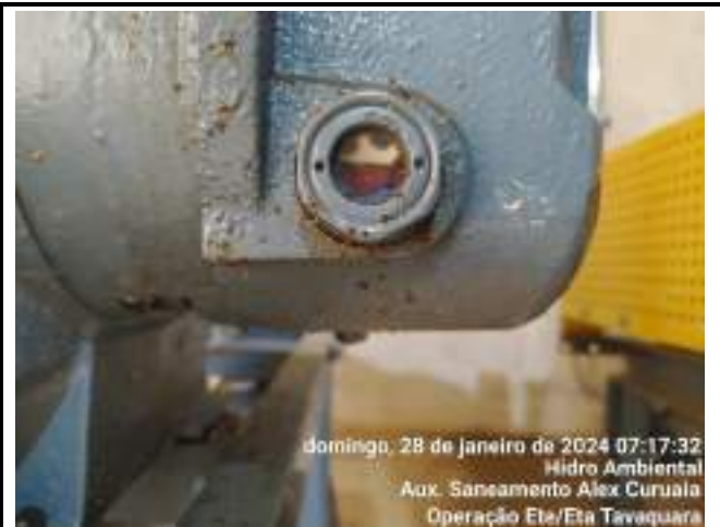
VERIFICAÇÃO DO ÓLEO DO SOPRADOR
