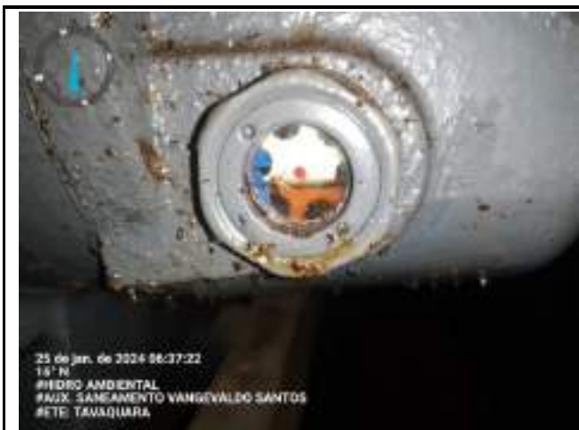
VERIFICAÇÃO DO ÓLEO DO SOPRADOR
