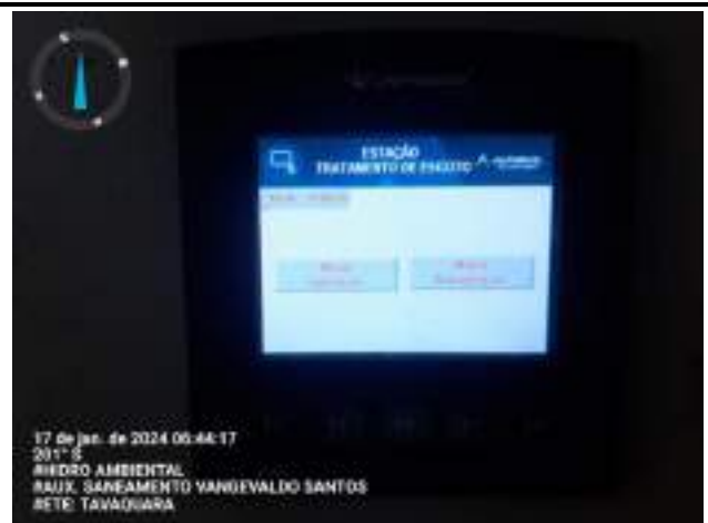
VERIFICAÇÃO DO PAINEL DE OPERAÇÃO
