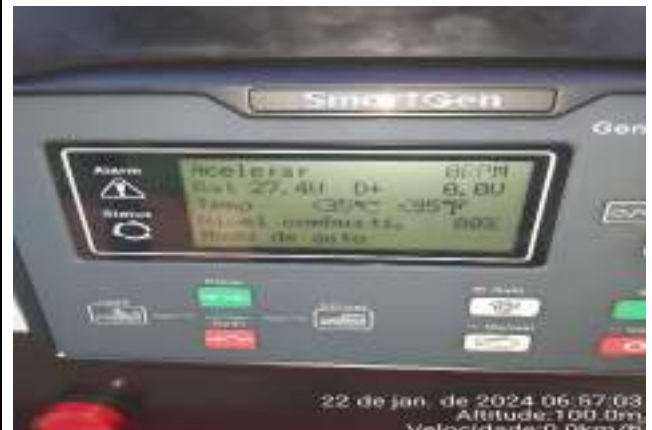
NÍVEL DO ÓLEO DO GERADOR NO FINAL DO TURNO
