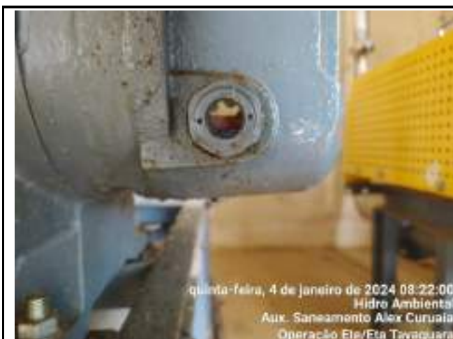
VERIFICAÇÃO DO ÓLEO DO SOPRADOR
