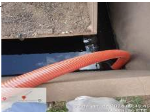
SUCÇÃO DA CAIXA DE CONTENÇÃO DOS KOMBIS
