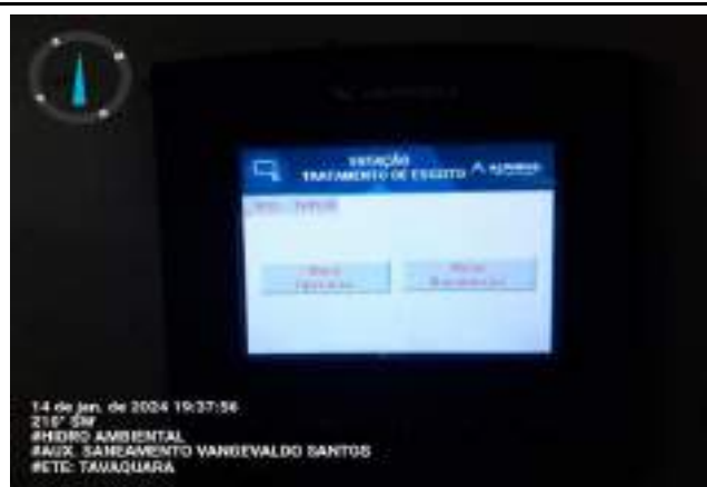
MONITORAMENTO DO PAINEL DE OPERAÇÃO
