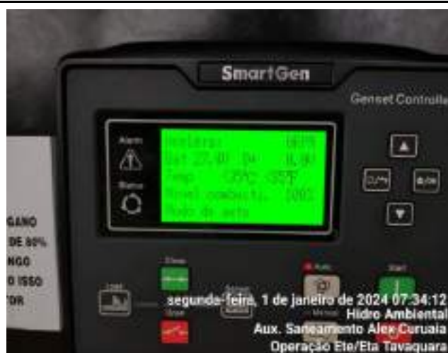
NÍVEL DO ÓLEO DO GERADOR EM 100%
