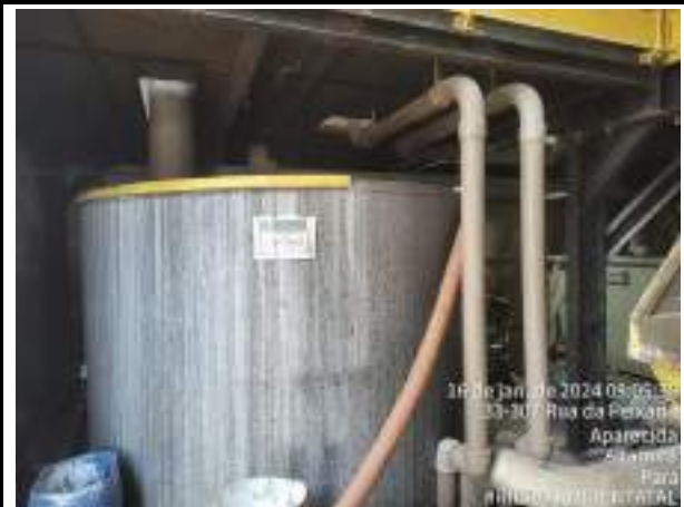
SUCÇÃO E LIMPEZA DO MISTURADOR DA CENTRÍFUGA
