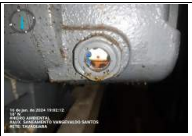
VERIFICAÇÃO DO ÓLEO DO SOPRADOR
