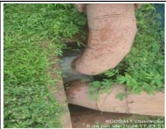
RETROLAVAGEM DO FILTRO 01 DE METAL DA VETA
