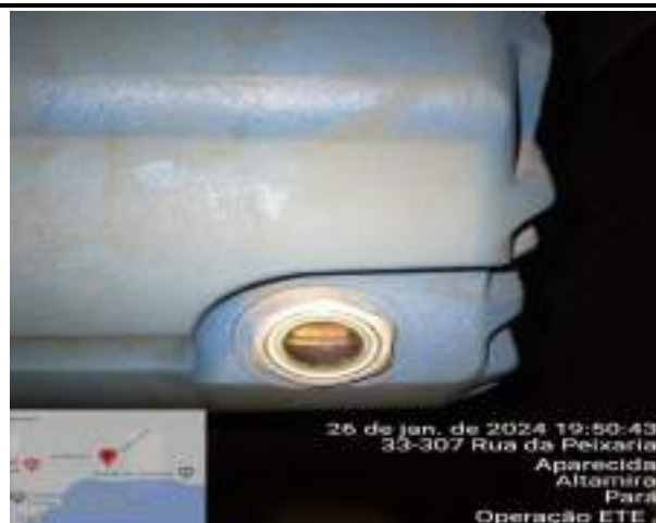
VERIFICAÇÃO DO ÓLEO DO SOPRADOR
