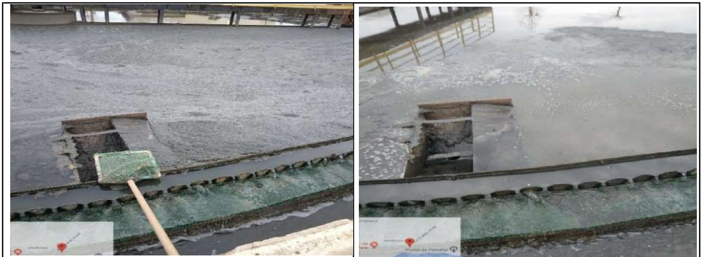
RETIRADA DE MATERIAL SOBRENADANTE DOS TANQUES DECANTADORES SECUNDÁRIOS DAS LINHAS A E B
