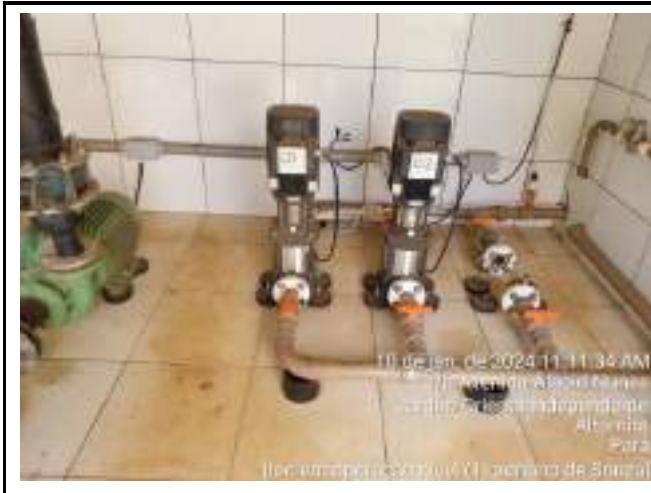
BOMBAS DE PRESSIRUZAÇÃO 01 LIGADA
