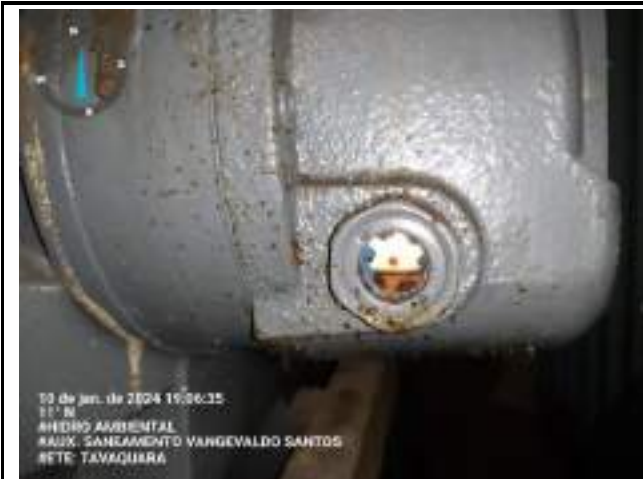
VERIFICAÇÃO DO ÓLEO DO SOPRADOR
