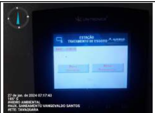
VERIFICAÇÃO DO PAINEL DE OPERAÇÃO
