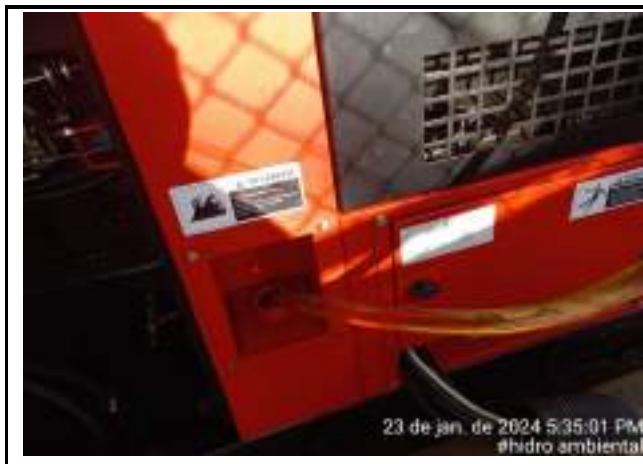
ABASTECIMENTO DO GERADOR
