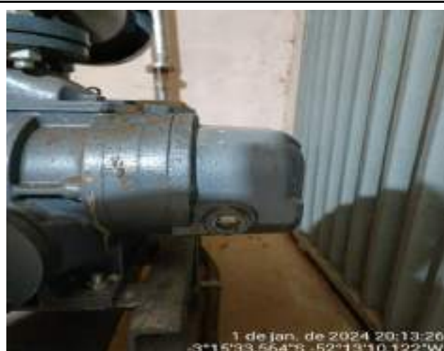
VERIFICAÇÃO DO ÓLEO DO SOPRADOR
