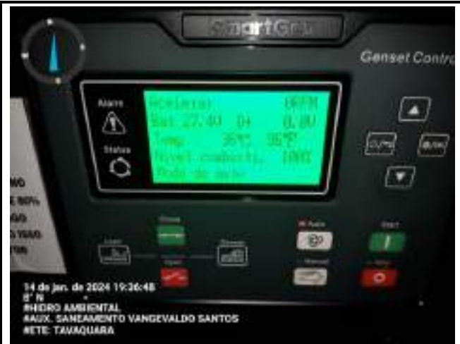
NÍVEL DO ÓLEO DO GERADOR NO FINAL DO TURNO
