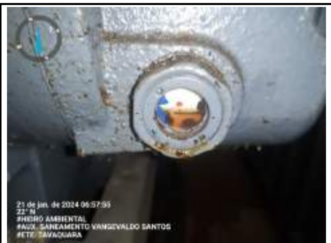
VERIFICAÇÃO DO ÓLEO DO SOPRADOR
