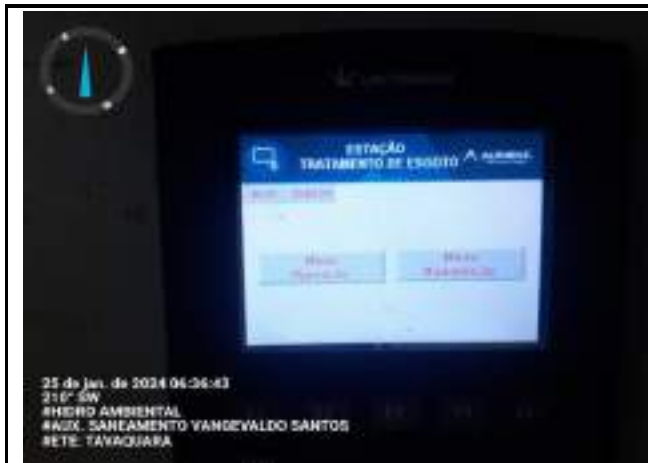
VERIFICAÇÃO DO PAINEL DE OPERAÇÃO
