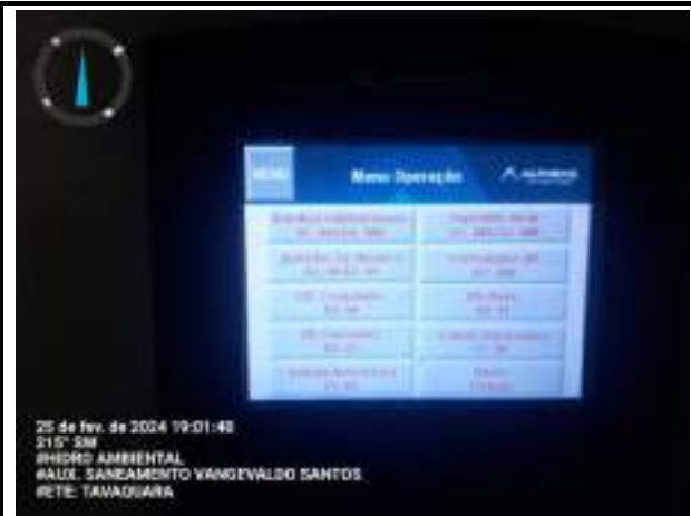
VERIFICAÇÃO DO PAINEL DOS EQUIPAMENTOS
