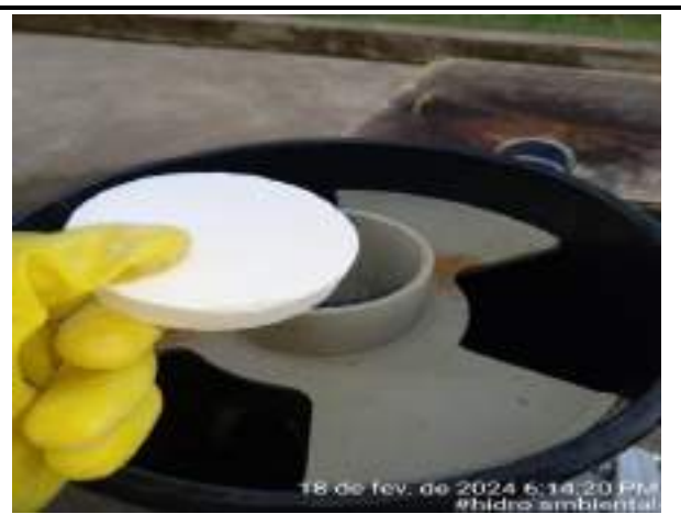
ADIÇÃO DE PASTILHA DE CLORO EMISSÁRIO FINAL
