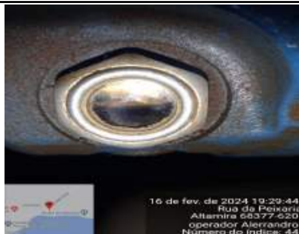
VERIFICAÇÃO DO ÓLEO DO SOPRADOR
