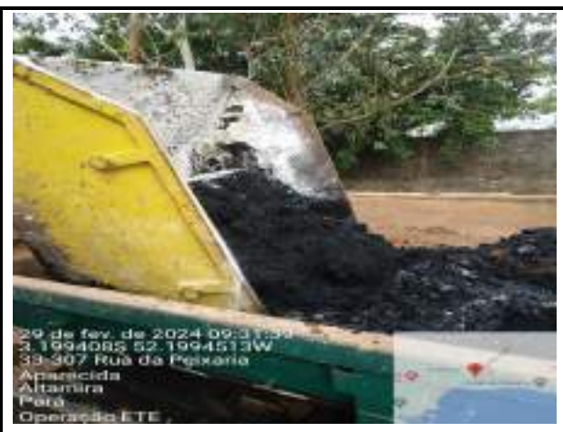
CENTRIFUGADO 4 M 3 DE LODO LINHA A
