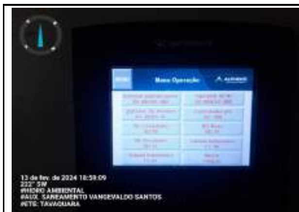
VERIFICAÇÃO DO PAINEL DOS EQUIPAMENTOS
