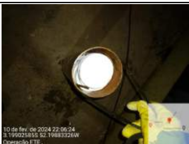
ADIÇÃO DE PASTILHA DE CLORO EMISSÁRIO FINAL
