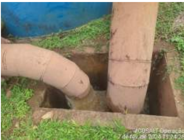
DESCARGA DE FUNDO NO FILTRO 01 DE METAL – VETA
