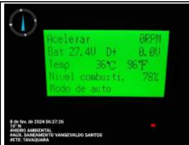
NÍVEL DO ÓLEO DO GERADOR
