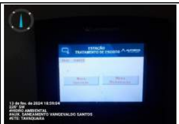
VERIFICAÇÃO DO PAINEL DE OPERAÇÃO
