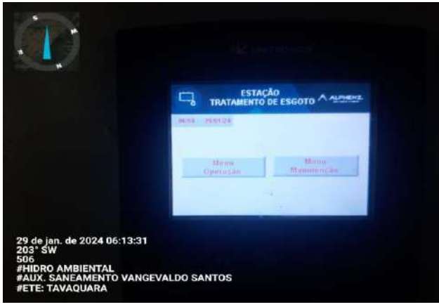
VERIFICAÇÃO PAINEL DE OPERAÇÃO
