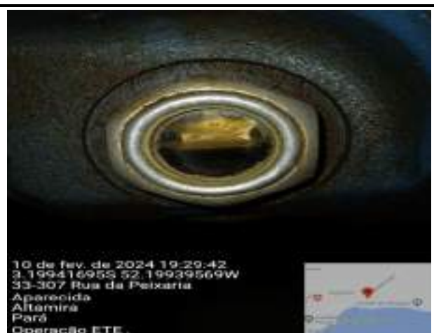
VERIFICAÇÃO DO ÓLEO DO SOPRADOR
