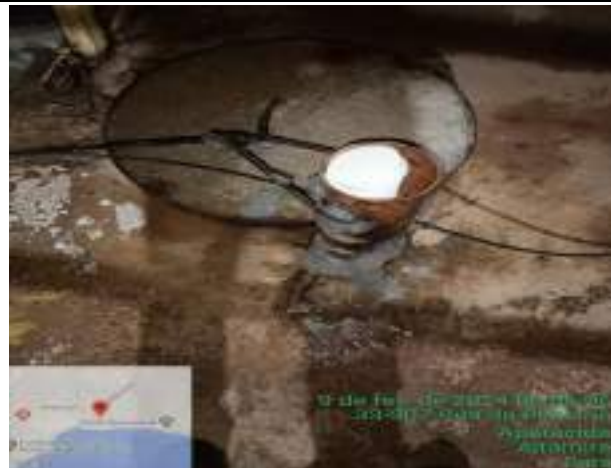
ADIÇÃO DE PASTILHA DE CLORO EMISSÁRIO FINAL
