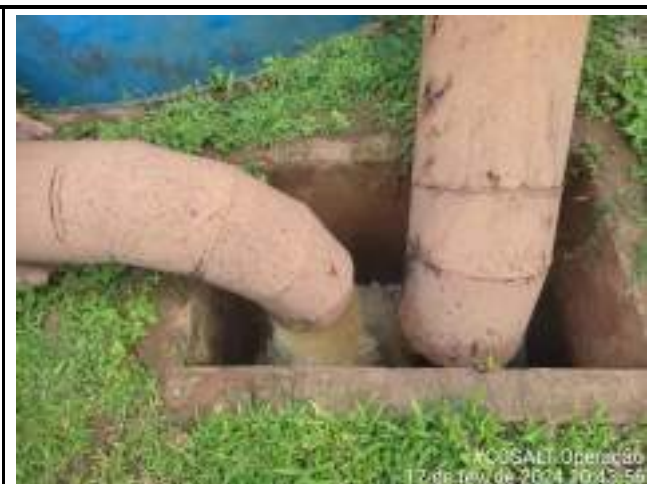
DESCARGA DE FUNDO DO FILTRO DE METAL 2 - VETA
