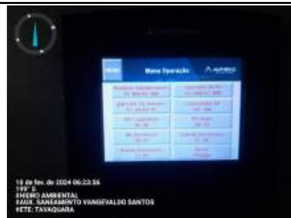
MONITORAMENTO DO PAINEL DE OPERAÇÃO
