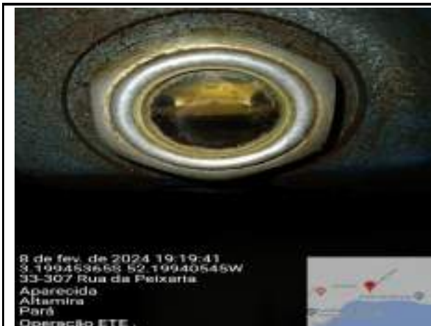
VERIFICAÇÃO DO ÓLEO DO SOPRADOR
