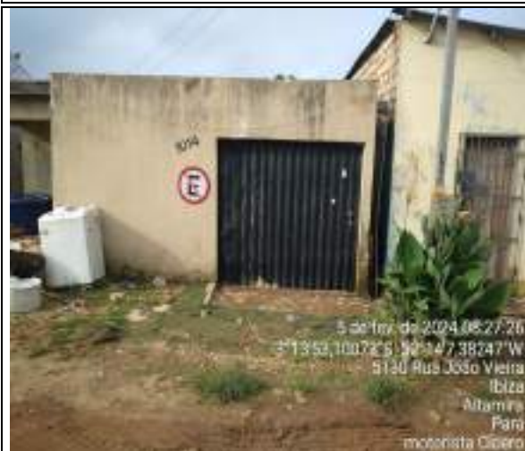
Figura 01: TRAVESSA JOÃO VIEIRA, 1014
