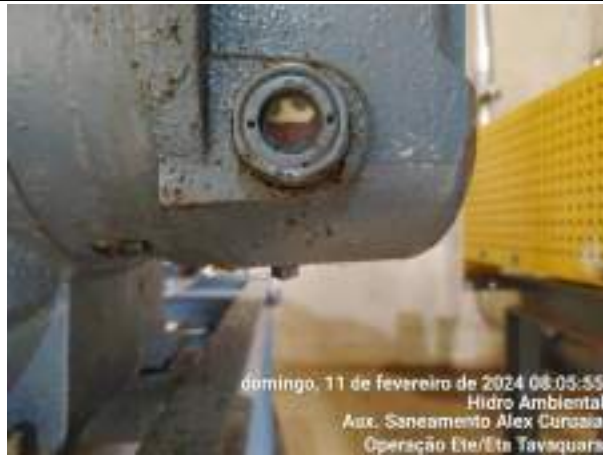
VERIFICAÇÃO DO ÓLEO DO SOPRADOR
