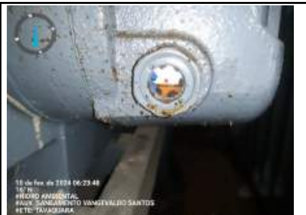
VERIFICAÇÃO DO ÓLEO DO SOPRADOR
