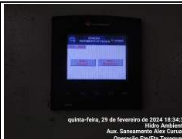
MONITORAMENTO DO PAINEL DE OPERAÇÃO
