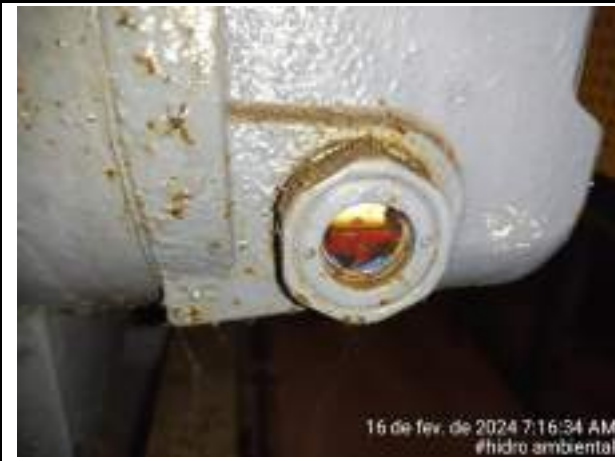
VERIFICAÇÃO DO ÓLEO DO SOPRADOR
