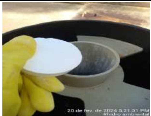
ADIÇÃO DE PASTILHA DE CLORO EMISSÁRIO FINAL
