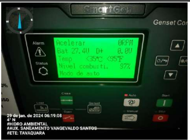
NÍVEL DO ÓLEO DO GERADOR
