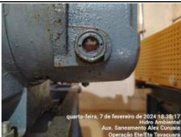
VERIFICAÇÃO DO ÓLEO DO SOPRADOR
