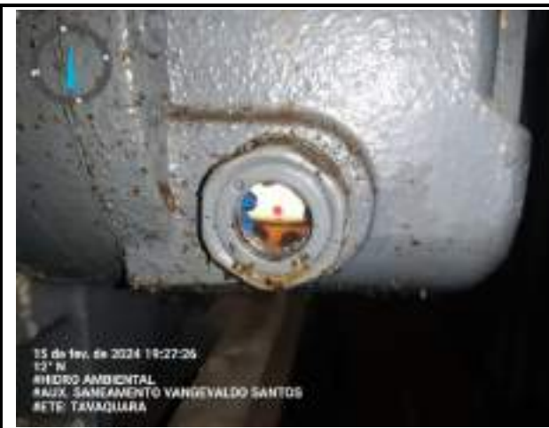
VERIFICAÇÃO DO ÓLEO DO SOPRADOR
