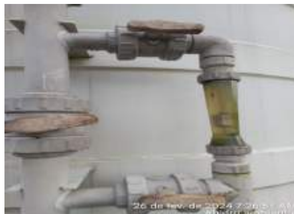
MONITORAMENTO DA VASÃO
