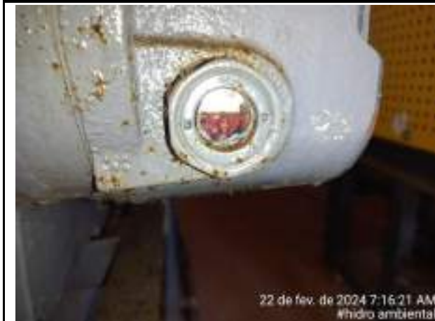
VERIFICAÇÃO DO ÓLEO DO SOPRADOR
