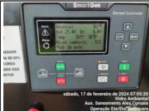
NÍVEL DO ÓLEO DO GERADOR
