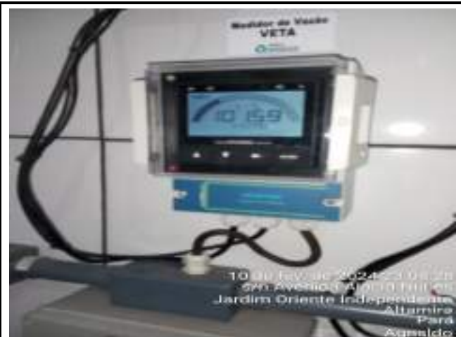
MONITORAMENTO DA VASÃO
