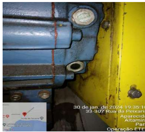
VERIFICAÇÃO DO ÓLEO DO SOPRADOR
