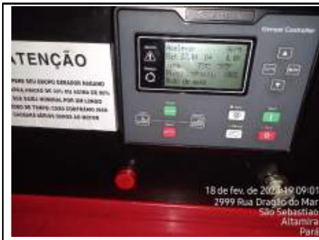
NÍVEL DO ÓLEO DO GERADOR
