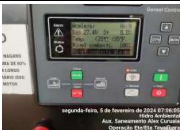
NÍVEL DO ÓLEO DO GERADOR
