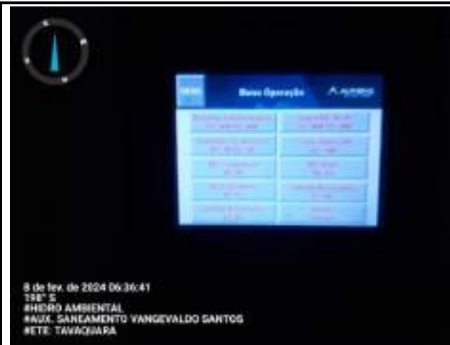
MONITORAMENTO DO PAINEL DE OPERAÇÃO
