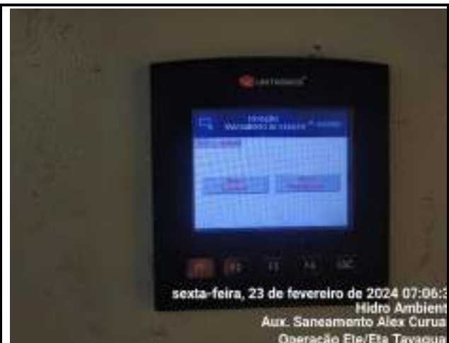
MONITORAMENTO DO PAINEL DE OPERAÇÃO
