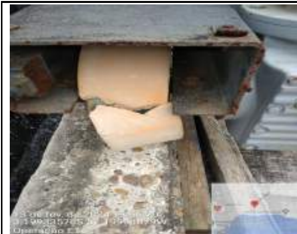
RODA DA PONTE REMOVEDORA DE LODO 2 DO TANQUE DECANTADOR SECUNDÁRIO LINHA B, ESTÁ DANIFICADA.
