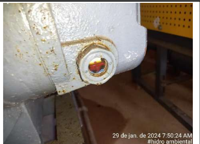
VERIFICAÇÃO DO ÓLEO DO SOPRADOR
