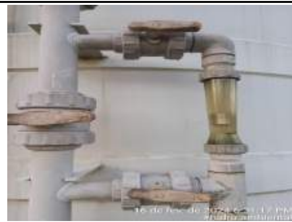
MONITORAMENTO DA VASÃO
