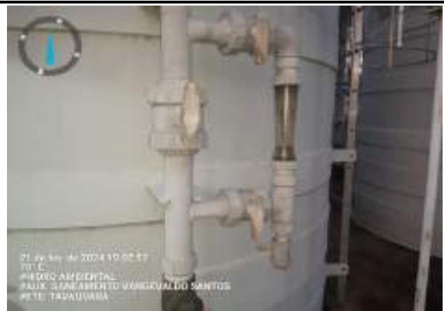
MONITORAMENTO DA VASÃO
