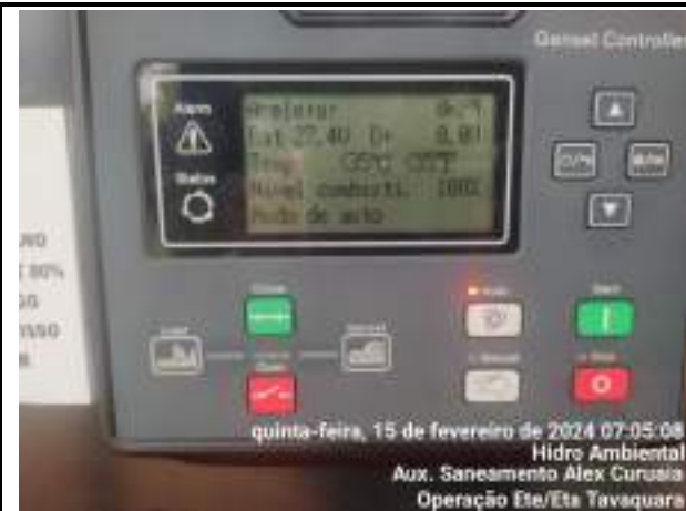
NÍVEL DO ÓLEO DO GERADOR
