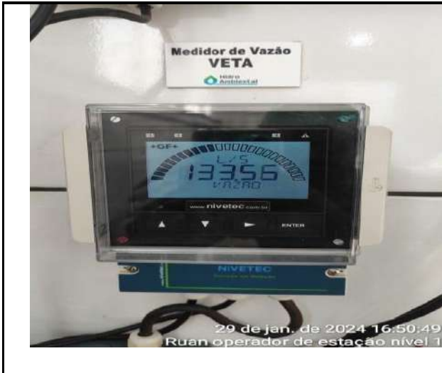
MONITORAMENTO DA VASÃO
