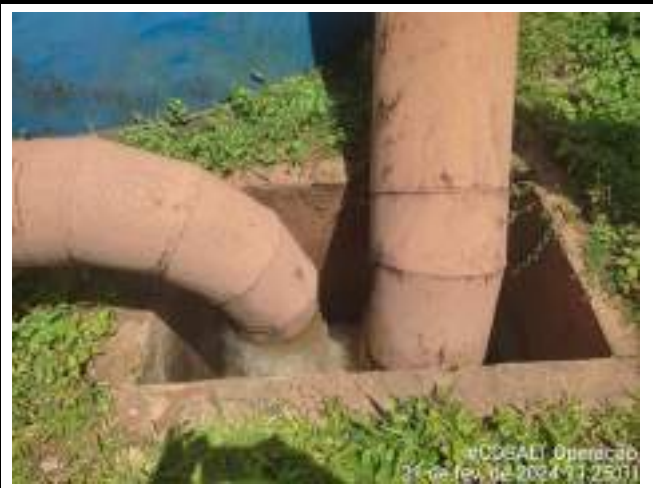
DESCARGA DE FUNDO DO FILTRO DE METAL 4 - VETA
