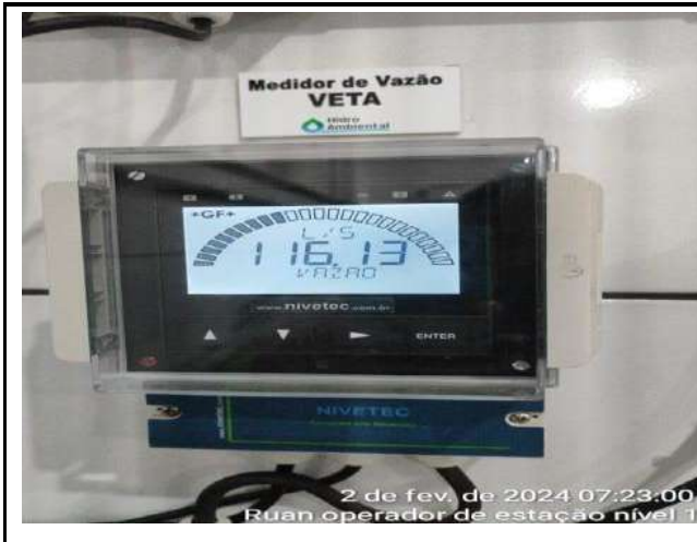
MONITORAMENTO DA VASÃO
