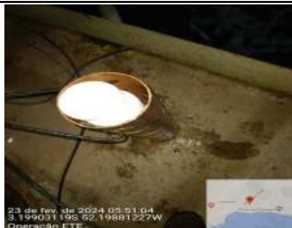
ADIÇÃO DE PASTILHA DE CLORO EMISSÁRIO FINAL
