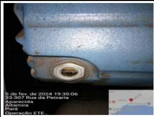
VERIFICAÇÃO DO ÓLEO DOS SOPRADORES
