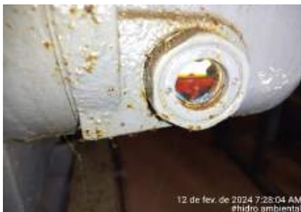
VERIFICAÇÃO DO ÓLEO DO SOPRADOR
