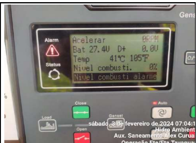
NÍVEL DO ÓLEO DO GERADOR
