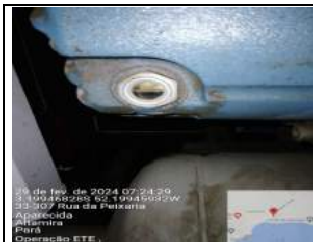
VERIFICAÇÃO DO ÓLEO DO SOPRADOR
