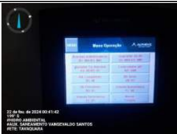
VERIFICAÇÃO DO PAINEL DOS EQUIPAMENTOS
