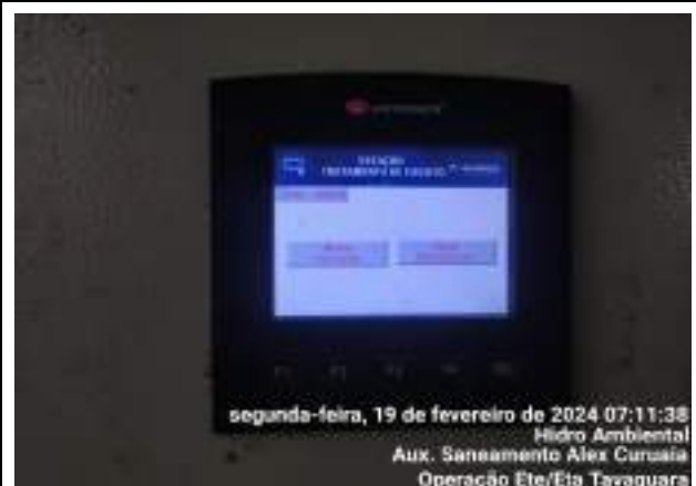
VERIFICAÇÃO DO PAINEL DE OPERAÇÃO
