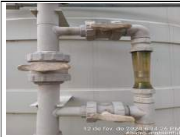
MONITORAMENTO DA VASÃO
