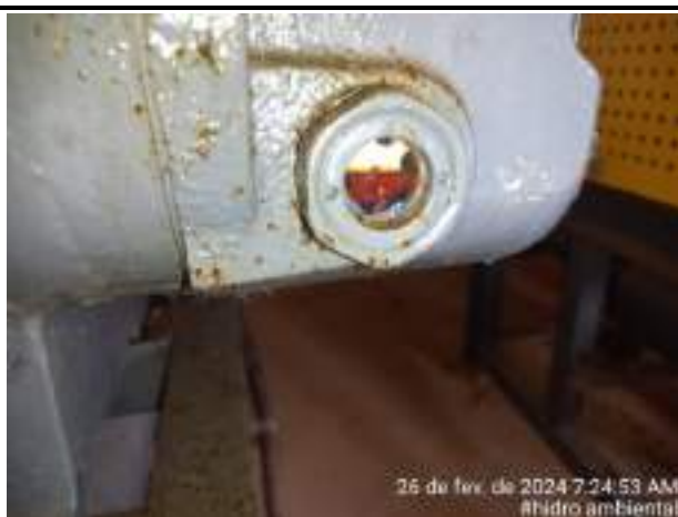
VERIFICAÇÃO DO ÓLEO DO SOPRADOR
