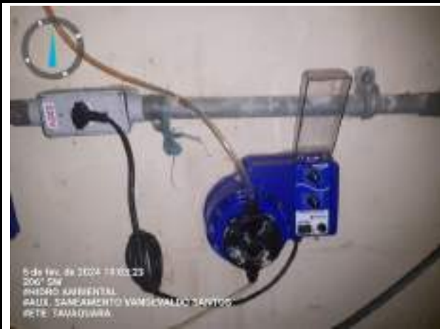
DOSADORA DESLIGADA POR FALTA DE PRODUTO
