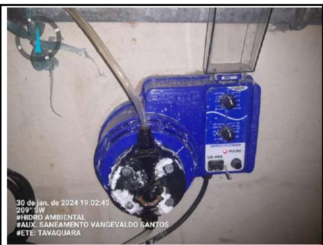
MONITORAMENTO DA DOSADORA DE BARRILHA
