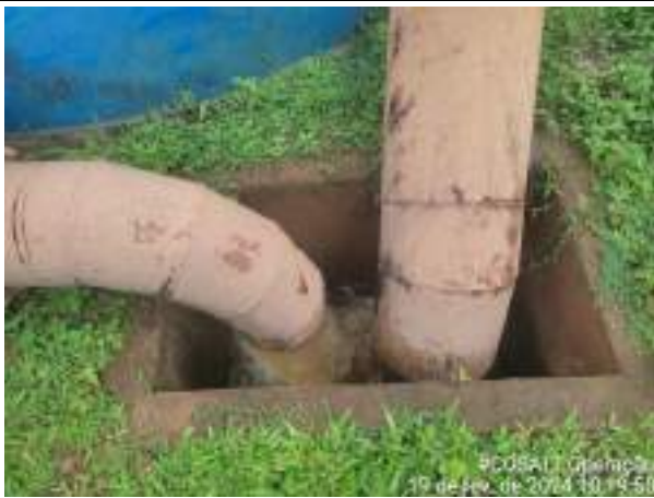
DESCARGA DE FUNDO DO FILTRO DE METAL 3 - VETA
