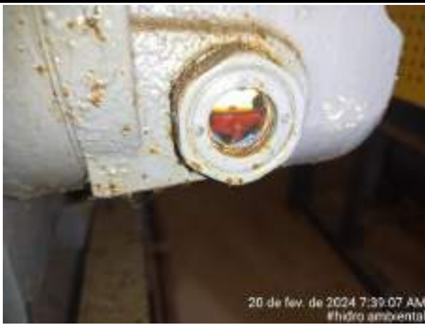
VERIFICAÇÃO DO ÓLEO DO SOPRADOR
