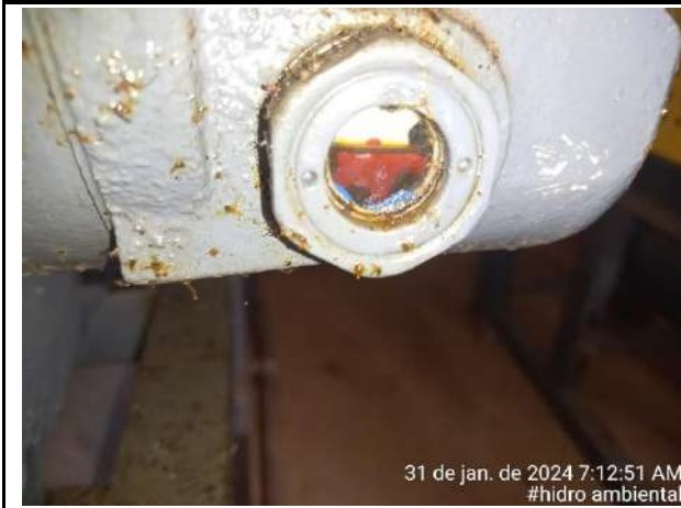
VERIFICAÇÃO DO ÓLEO DO SOPRADOR
