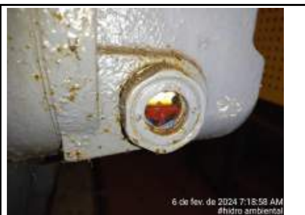
VERIFICAÇÃO DO ÓLEO DO SOPRADOR
