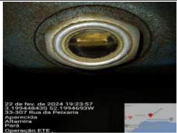
VERIFICAÇÃO DO ÓLEO DO SOPRADOR
