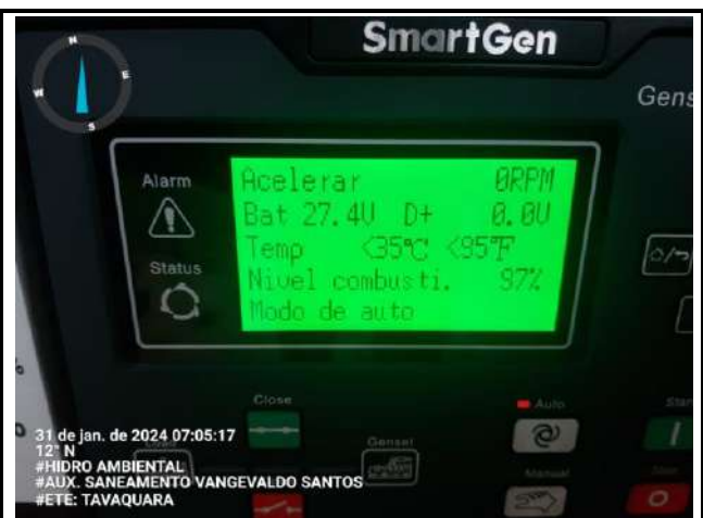
NÍVEL DO ÓLEO DO GERADOR INICIO DO TURNO
