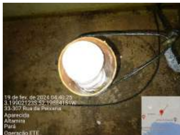
ADIÇÃO DE PASTILHA DE CLORO EMISSÁRIO FINAL
