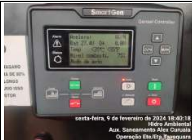
NÍVEL DO ÓLEO DO GERADOR
