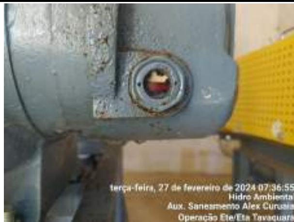
VERIFICAÇÃO DO ÓLEO DO SOPRADOR
