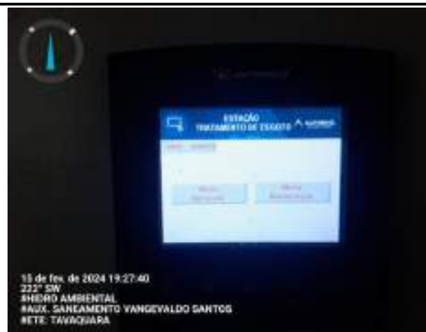
MONITORAMENTO DO PAINEL DE OPERAÇÃO
