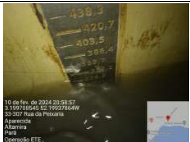
MONITORAMENTO DA VASÃO
