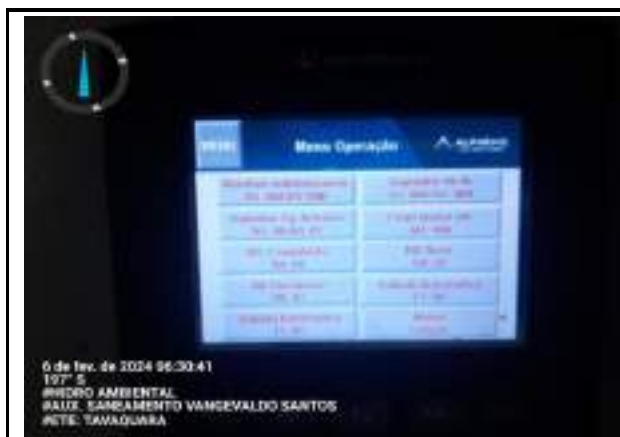
VERIFICAÇÃO DO PAINEL DOS EQUIPAMENTOS
