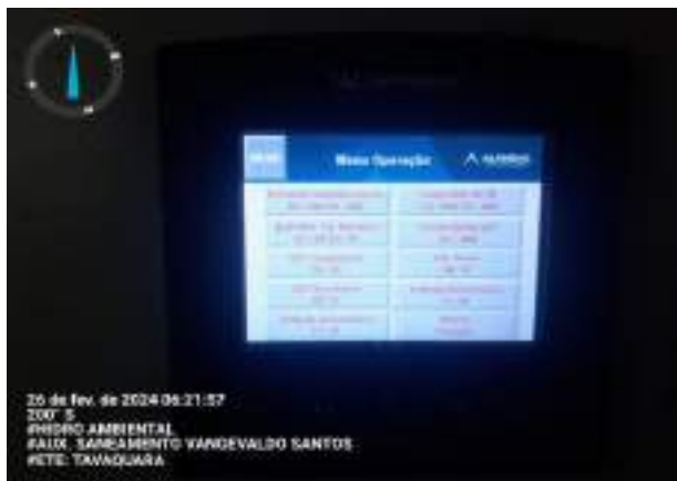
VERIFICAÇÃO PAINEL DOS EQUIPAMENTOS
