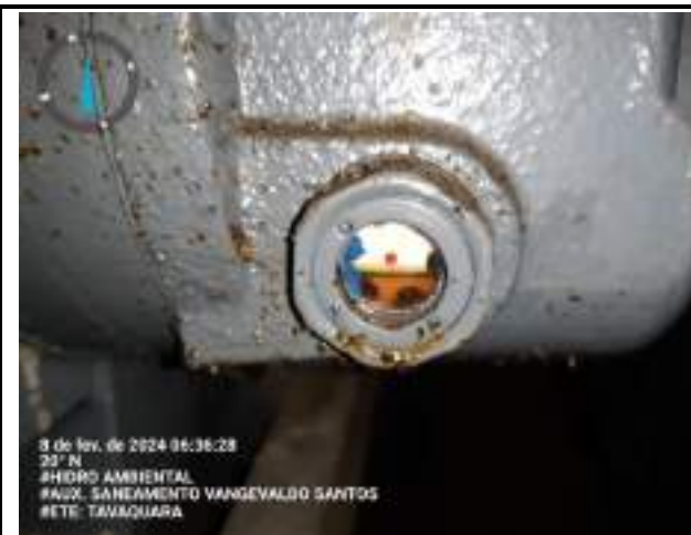
VERIFICAÇÃO DO ÓLEO DO SOPRADOR
