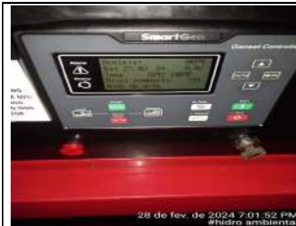
NÍVEL DO ÓLEO DO GERADOR
