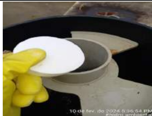
ADIÇÃO DE PASTILHA DE CLORO EMISSÁRIO FINAL
