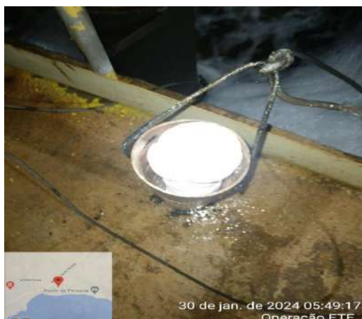
ADIÇÃO DE CLORO EMISSÁRIO FINAL
