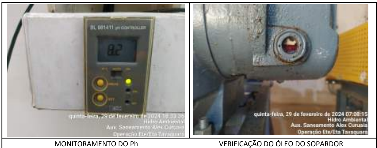
VERIFICAÇÃO DO FUNCIONAMENTO DOS EQUIPAMENTOS DA ELEVATÓRIA DE DISTRIBUIÇÃO DE ÁGUA
