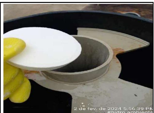
ADIÇÃO DE CLORO EMISSÁRIO FINAL
