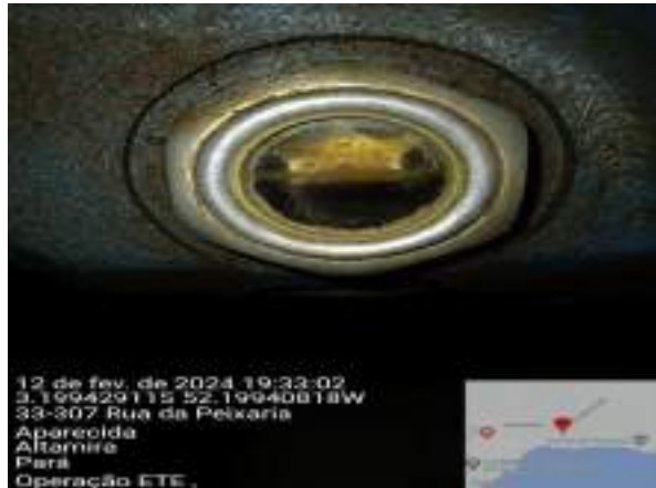
VERIFICAÇÃO DO ÓLEO DOS SOPRADORES
