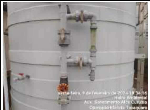
MONITORAMENTO DA VASÃO
