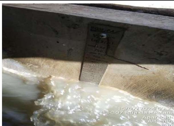
MONITORAMENTO DA VASÃO LINHA A
