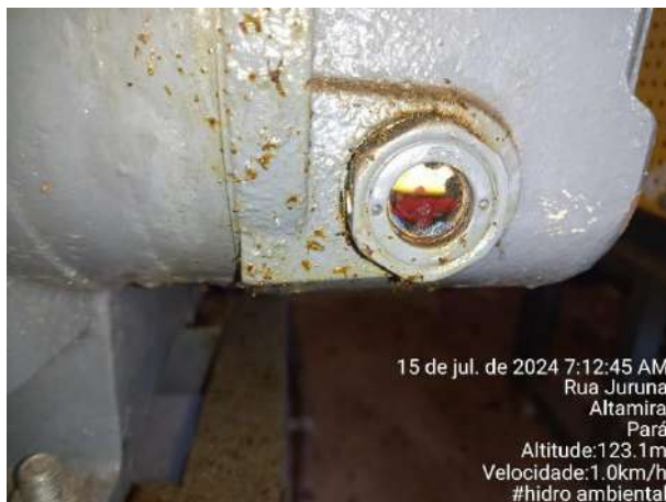
VERIFICAÇÃO DO ÓLEO DO SOPRADOR
