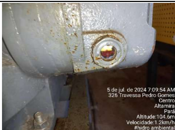
VERIFICAÇÃO DO ÓLEO DO SOPRADOR
