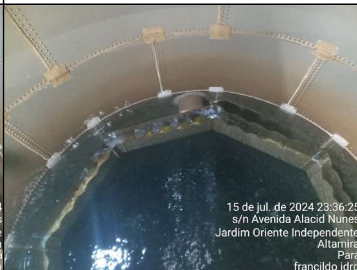
4: LAVAGEM DOS FILTROS
