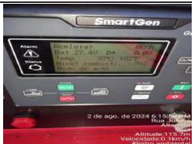
NIVEL DO ÓLEO DO GERADOR
