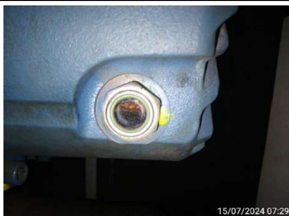
VERIFICAÇÃO DO ÓLEO DO SOPRADOR
