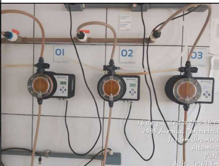
6: LIMPEZA DA DOSADORA 1,2 E 3 DE PAC.
