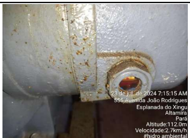
VERIFICAÇÃO DO ÓLEO DO SOPRADOR
