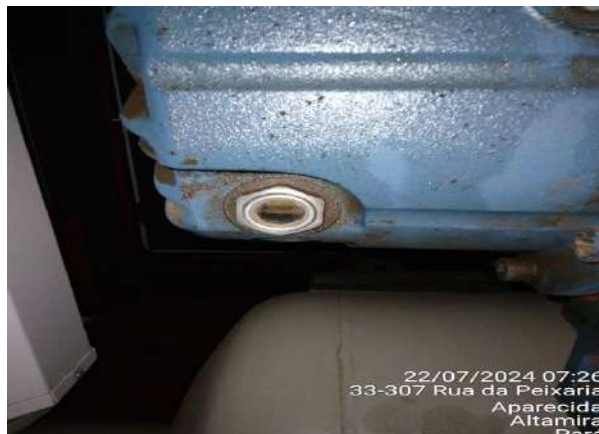
VERIFICAÇÃO DO ÓLEO DO SOPRADOR
