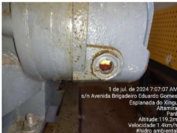
VERIFICAÇÃO DO ÓLEO DO SOPRADOR
