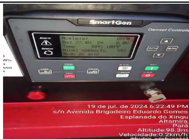
NÍVEL DO ÓLEO DO GERADOR
