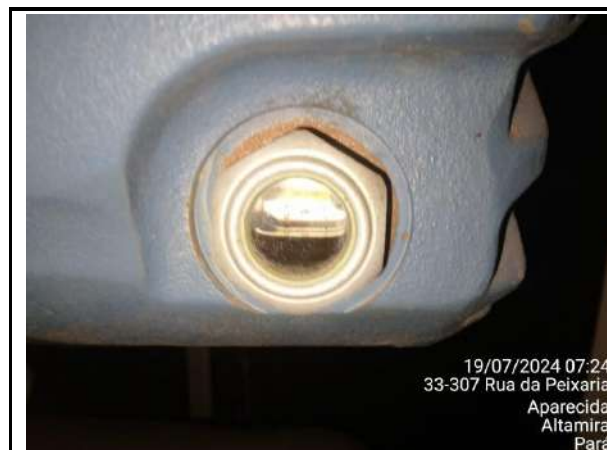
VERIFICAÇÃO DO ÓLEO DO SOPRADOR
