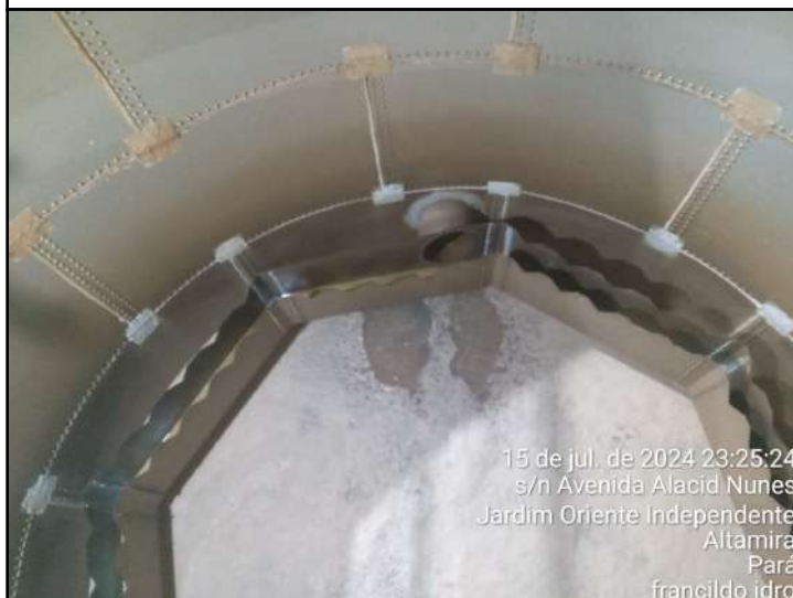
3: LAVAGEM DOS FILTROS
