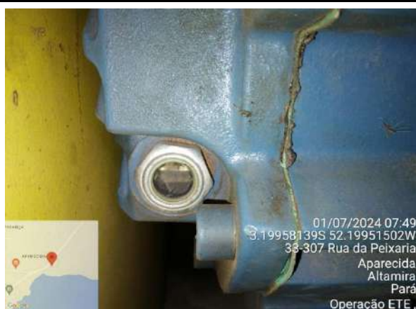
VERIFICAÇÃO DO ÓLEO DO SOPRADOR
