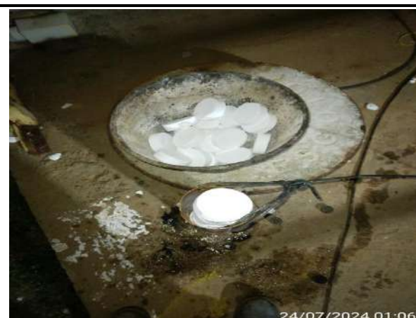
ADIÇÃO DE PASTILHA DE CLORO EMISSÁRIO FINAL
