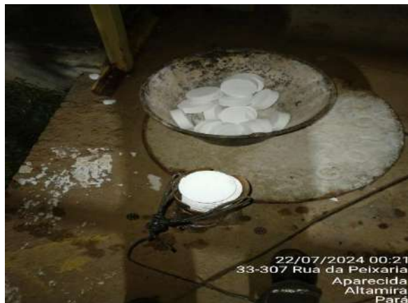
ADIÇÃO DE PASTILHA DE CLORO EMISSÁRIO FINAL
