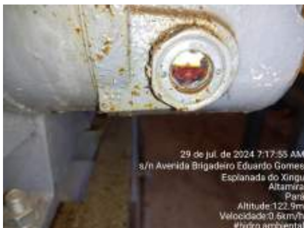
VERIFICAÇÃO DO ÓLEO DO SOPRADOR
